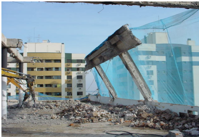
Figura 14: vista do colapso provocado da peça estrutural
