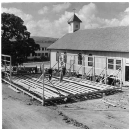
34 – Construção do grupo escolar das irmãs pallotinas, junto à Igreja Nossa Senhora de Fátima. A escola passaria a se chamar Doutor Edmundo Gardolinski em homenagem ao engenheiro construtor da Vila do IAPI.
