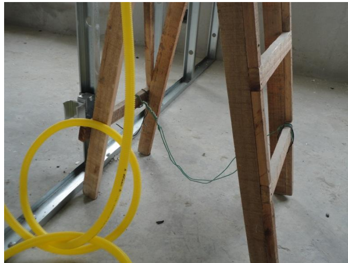
Figura 18 – Escada não adequada
