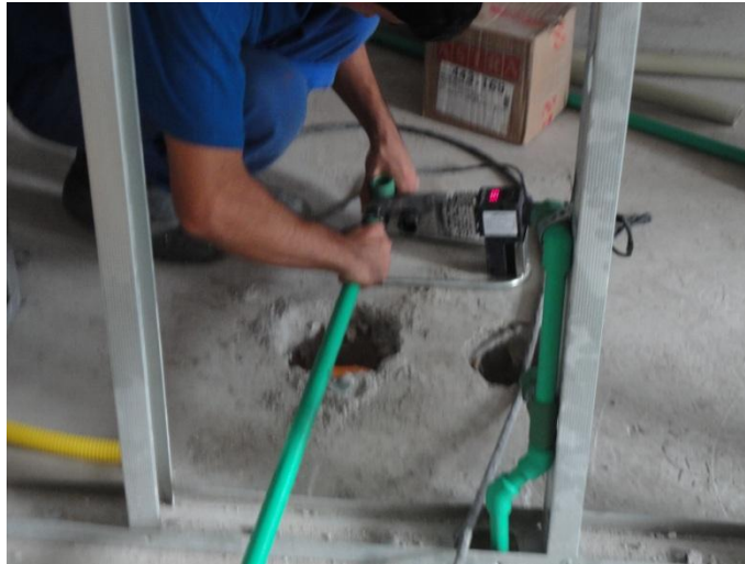
Figura 25 – Ausência de bancada de trabalho
