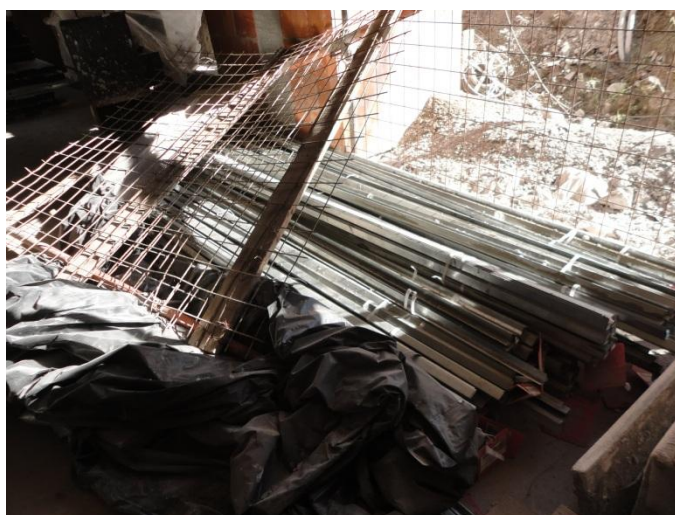
Figura 14 – Armazenamento dos frames em local não adequado
