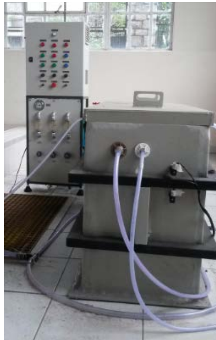
Figura 4.2: Vista frontal do sistema piloto de UF instalado nas dependências do DMAE.
