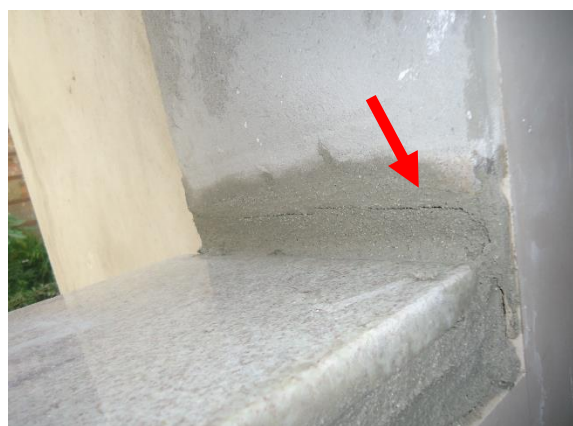
Figura 31 – Fissura no canto inferior do vão
