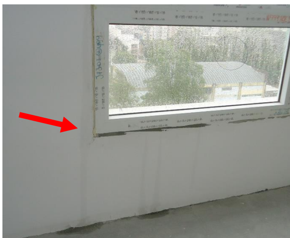
Figura 42 – Infiltração pelas folgas laterais e inferiores do vão
