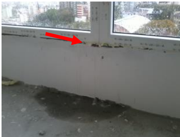
Figura 41 – Infiltração na região central inferior da esquadria
