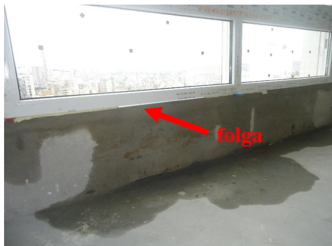
Figura 44 – Infiltração por falta de arremate de vedação e folga inferior do vão
