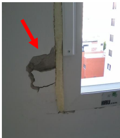
Figura 36 – Descolamento do revestimento de argamassa próximo ao ponto de fixação lateral
