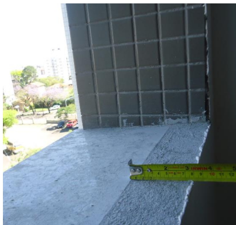
Figura 33 – Preenchimento do peitoril com medida superior ao perfil da esquadria
