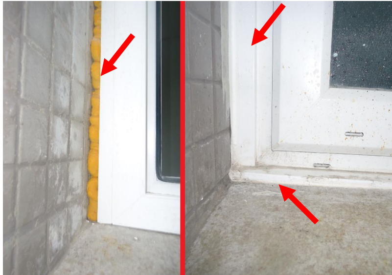
Figura 39 – Vista externa da esquadria antes e depois da colocação do perfil adaptado de arremate
