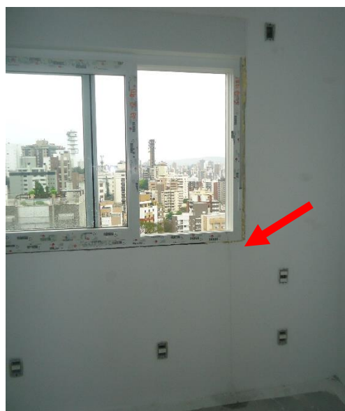
Figura 46 – Infiltração no canto de esquadria com folga
