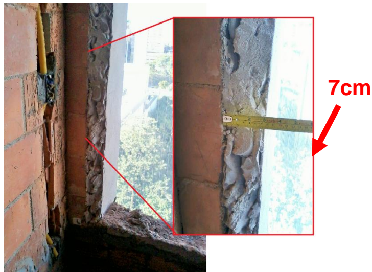
Figura 12 – Espessura de requadro acima do máximo recomendado
