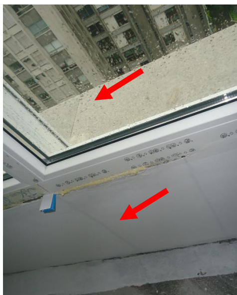
Figura 45 – Infiltração através de falha na vedação do peitoril
