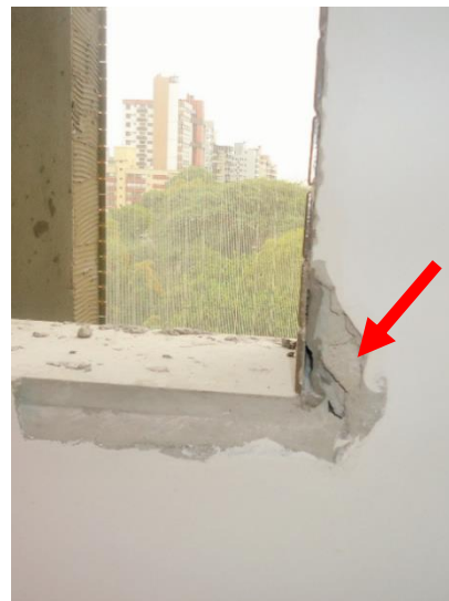
Figura 14 – Fissuras no canto inferior do vão
