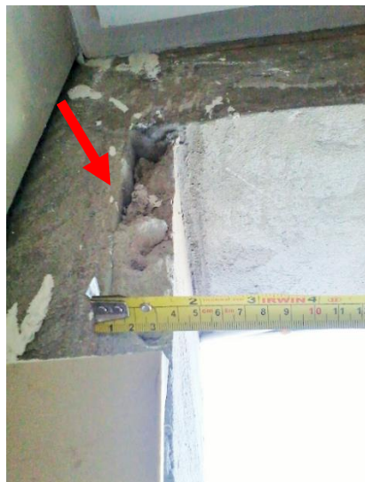
Figura 13 – Descolamento do revestimento de argamassa no vão
