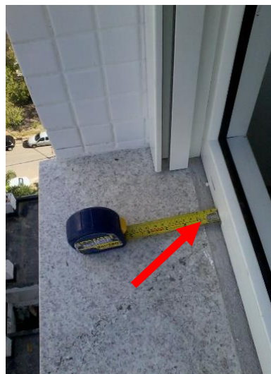
Figura 40 – Esquadria não instalada sobre o peitoril de granito
