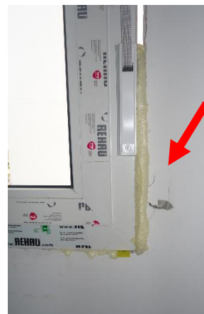
Figura 37 – Fissura próxima ao ponto de fixação lateral
