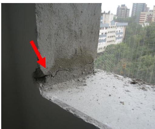
Figura 30 – Fissura no canto inferior do vão
