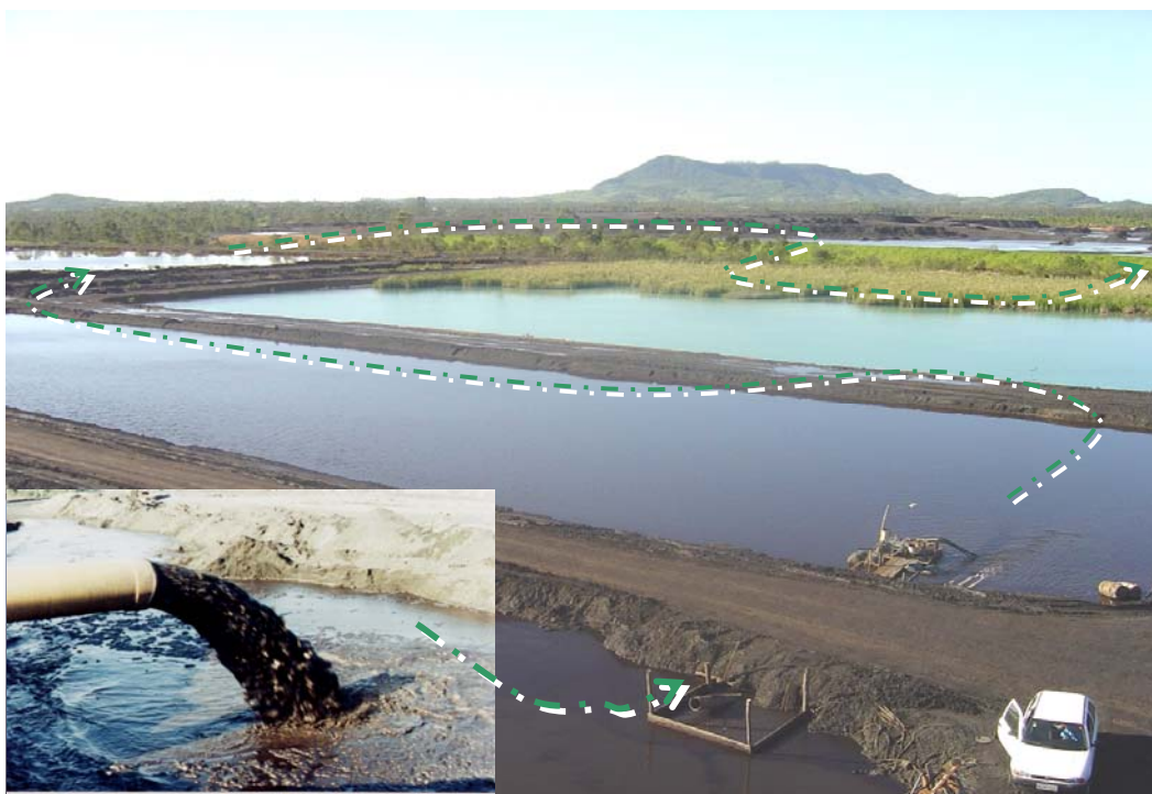
Figura 21. No detalhe, descarga do efluente da usina de beneficiamento no primeiro decantador do Módulo A, e vista parcial de 3 dos 4 decantadores, sendo indicado o sentido do fluxo laminar do efluente.
