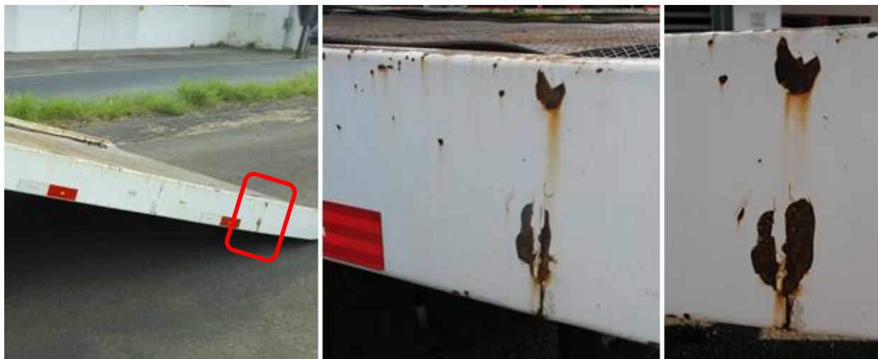
Figura 5.5 – Trincas identificadas na estrutura da plataforma.
