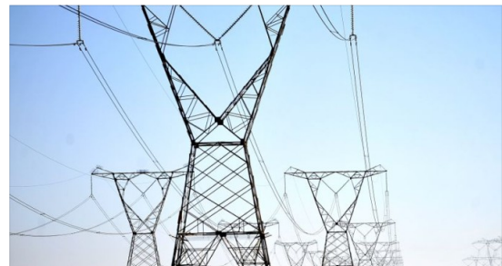
Cabos de linhas de transmissão (Companhia Estadual de Energia Elétrica, 2014[26])
