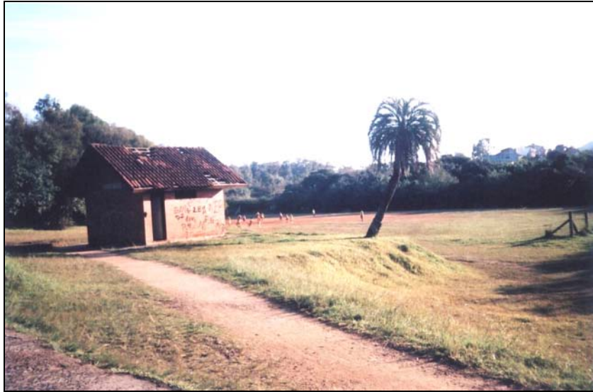
Figura 28 - Fotografia do banheiro depredado no Parque Chico Mendes Fonte: O autor (jun. 2006).
