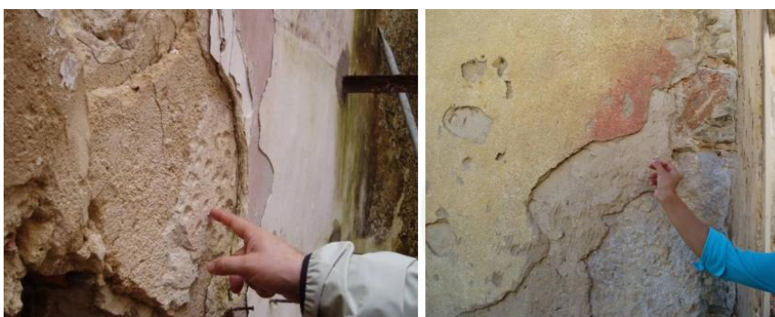
Figura 20 – argamassa de cal, do século XIX, em várias camadas e com colorações características
