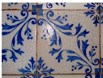
Figura 24 – padrão de craquelé em azulejos de fachada em Lisboa, Portugal
