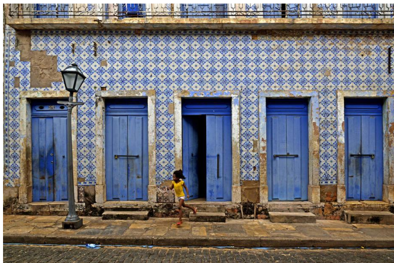
Figura 109 – fachada azulejada em progressivo estado de degradação em São Luís, Maranhão, Brasil
