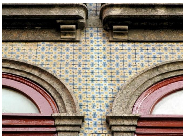
Figura 16 – fachada com azulejos franceses, de Pays du Calais, séc. XIX. Rio de Janeiro, Brasil
