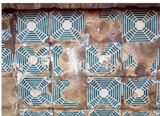
Figura 107 – estágio terminal da degradação com sinais de cristalizações salinas
