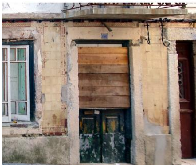
Figura 29 – estágio final da degradação da fachada com a perda total dos azulejos e descaracterização do imóvel quanto ao seu valor histórico, em Lisboa, Portugal
