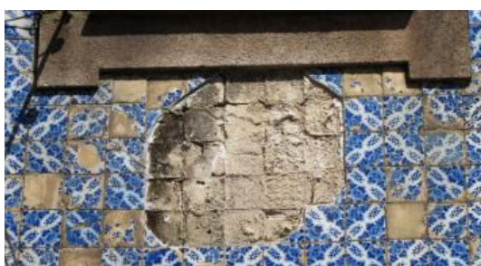
Figura 101 – fachada com falta de azulejos e com assentamento utilizando argamassa de cimento.
