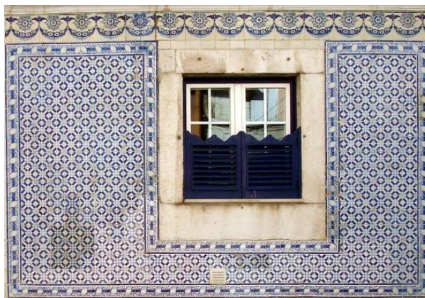
Figura 103 – fachada azulejada com manchas decorrentes do excesso de água
