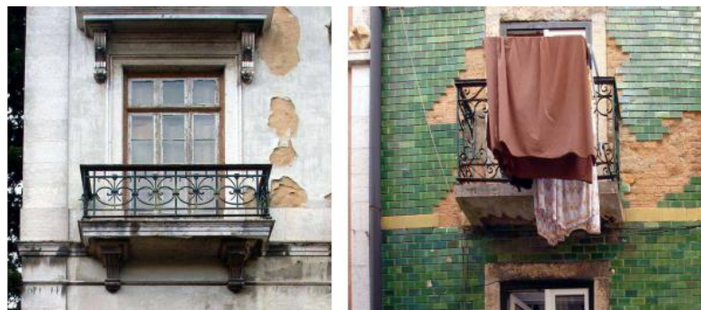
Figura 105 – perda de vários azulejos em fachada devido ao excesso de umidade
