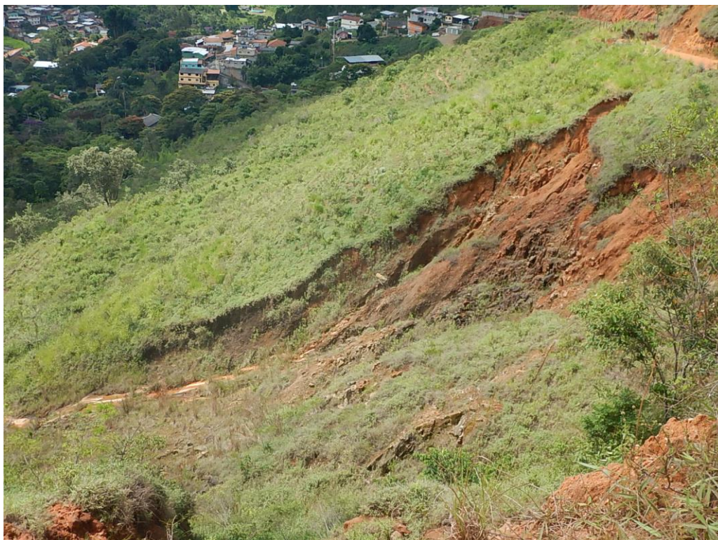
Figura 26 – Visão geral da ruptura do ponto 06
