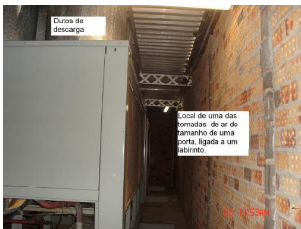
Figura 7.7 – Enclausuramento de Chiller a ar
