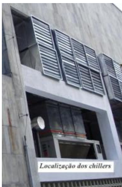
Figura 7.8 – Tratamento acústico na descarga dos ventiladores
