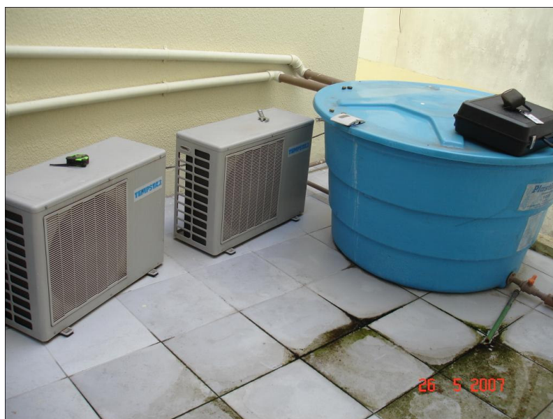
Figura 8.10 – Condensadoras split de 36.000 Btu/h (10,55 kW)
