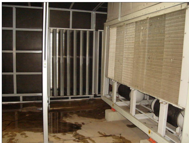
Figura 8.8 – Vista interna da nova instalação
