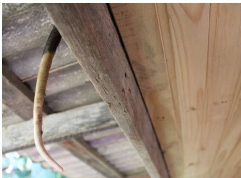
Fig. 10: Gambás no forro do telhado. Foto: Janice Martins Appel.
