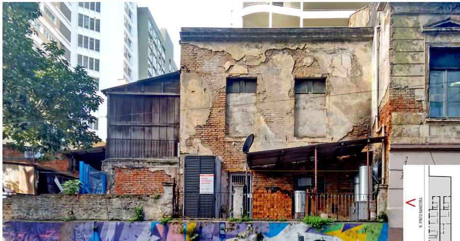
Figura 38 - Anexos na fachada da Rua Pinto Bandeira - péssimo estado de conservação
