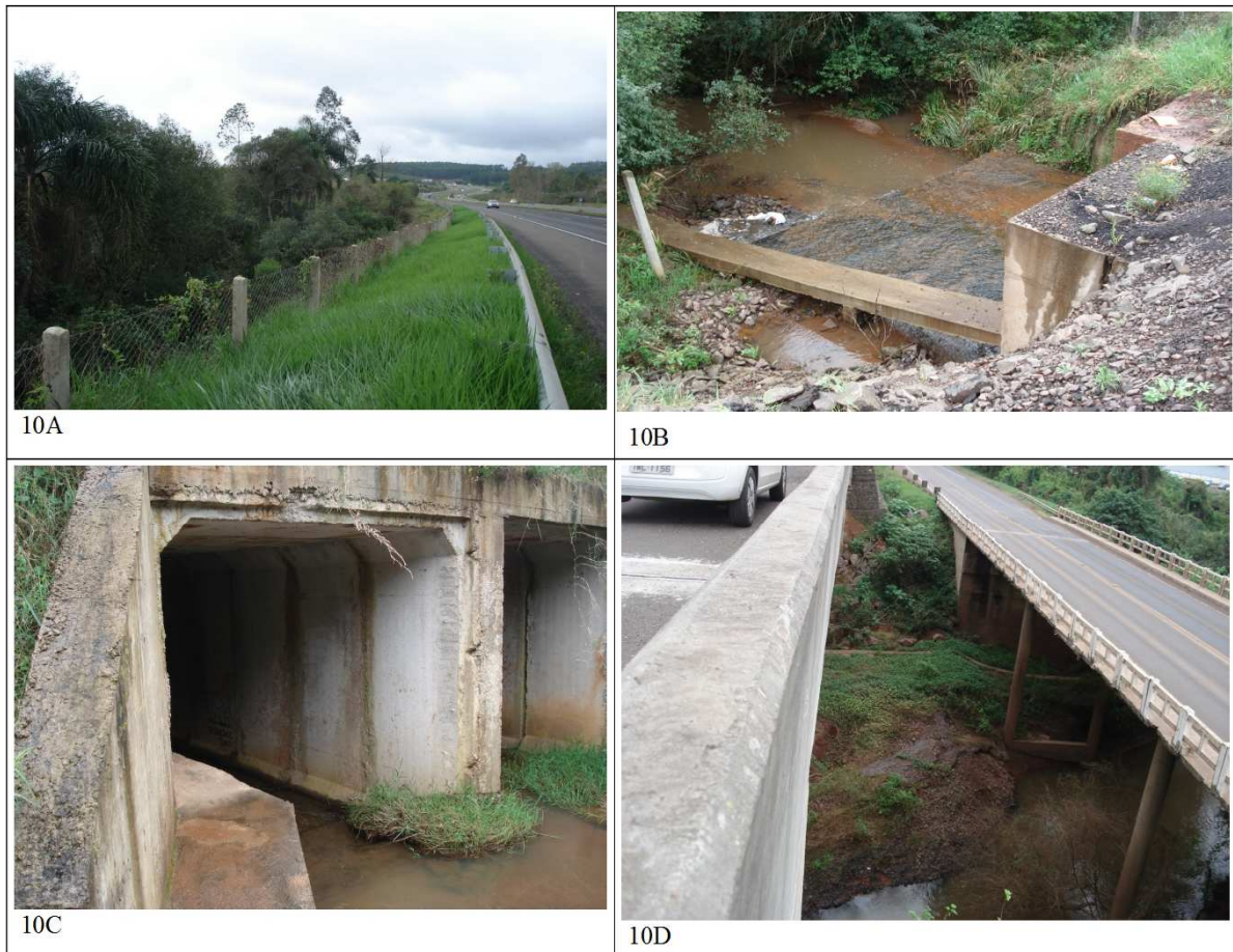
10A) Cerca guia para direcionamento da fauna às passagens secas; 10B) Bueiro sob a pista da rodovia com passagem seca para a fauna; 10C) Bueiro com passagem seca para a fauna; 10D) Passagem seca sob a ponte do arroio Estrela. Fonte: Arquivo pessoal, 2015.
