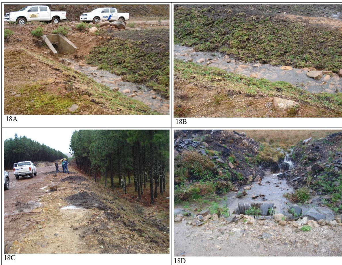
18A) Manutenção dos sistemas de drenagem durante a interrupção das obras; 18B) Valas de drenagem enleivadas; 18C) Taludes laterais enleivados; 18D) Caixas de drenagem instaladas.
