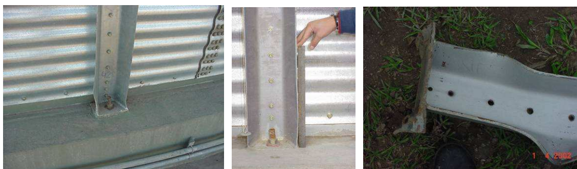
Figura 2.8 – Fotos de montantes com problema de flambagem local das abas.
