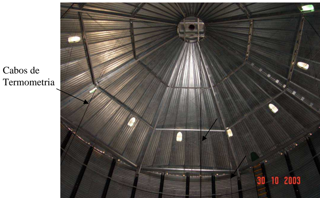
Figura 3.3 – Fotos de cabos de termometria em silo com estrutura sob o telhado.
