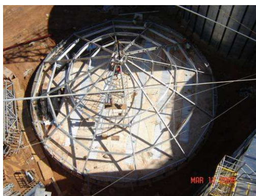
Figura 3.2 – Foto da montagem da estrutura sob telhado de um silo de 21,82m de diâmetro.
