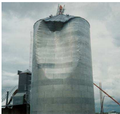
Figura 2.9 – Foto de Silo mal dimensionado ao vento.
