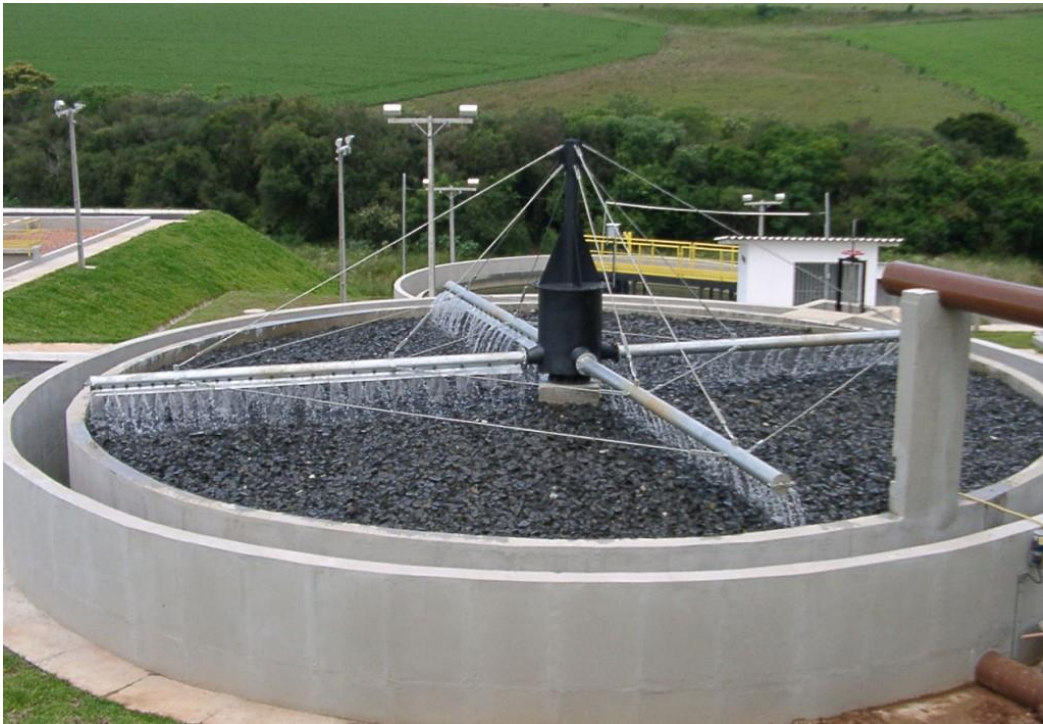
Figura 3 – Reator biológico com Pedra Britada Nº 4
