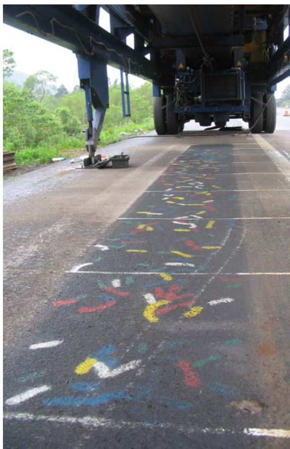
Figura 68: Seção Teste 2, com a demarcação das trincas, após os ensaios com o simulador de tráfego estarem encerrados.
