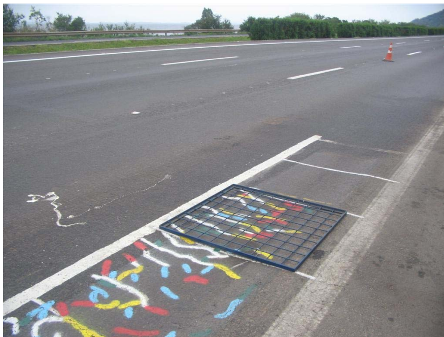
Figura 43: Grade metálica auxiliando na transposição das trincas para papel milimetrado e, posteriormente, para via digital
