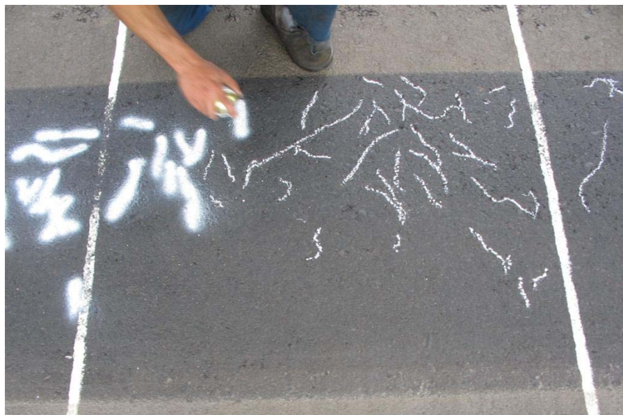
Figura 42: Demarcação das trincas nas seções ensaiadas pelo simulador de tráfego nesta pesquisa.
