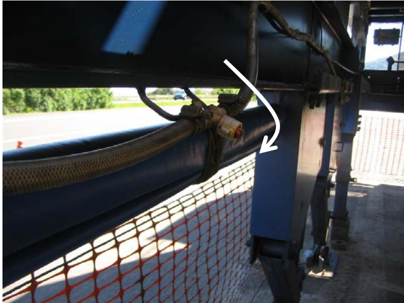
Figura 35: Detalhe de um dos espargidores de água que simulam as precipitações pluviométricas no simulador de tráfego.
