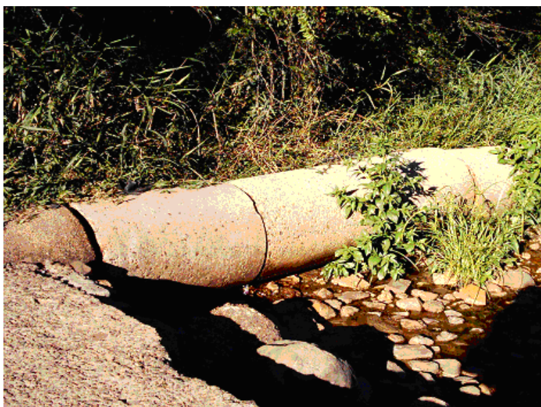
Figura 12. Depósito irregular de esgoto em Restinga Seca
