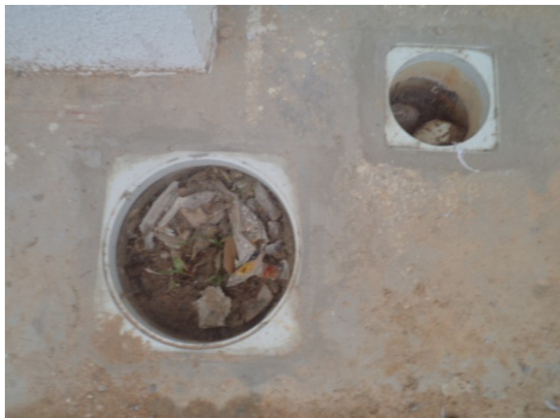
Figura 35 – Acúmulo de resíduos nas caixas coletoras de esgoto
