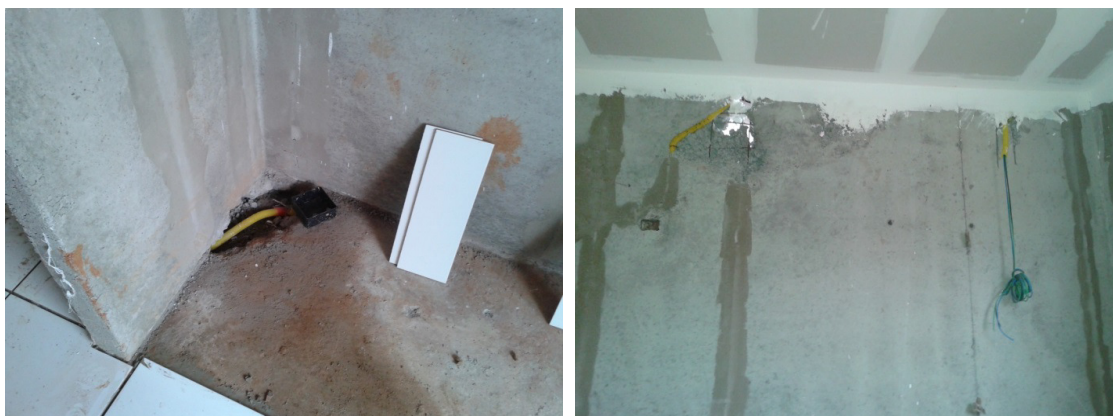
Figura 27, 28 e 29 – Problemas de embutimento das tubulações elétricas no radier e paredes
