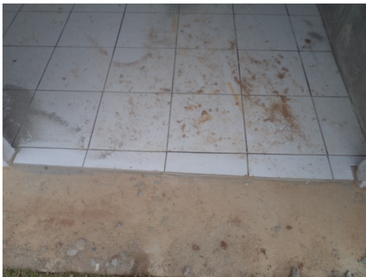
Figura 36 – Casa fora de esquadro
