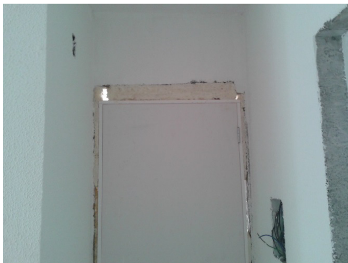
Figura 24 – Vão da porta de entrada com incompatibilidade de dimensão
