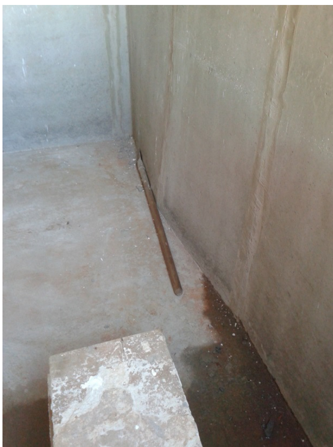
Figura 37 – Parede concretada com fôrma posicionada de maneira inadequada
