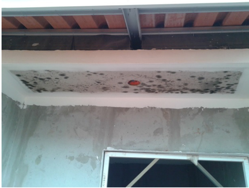
Figura 34 – Aparecimento de fungos no forro devido à umidade
