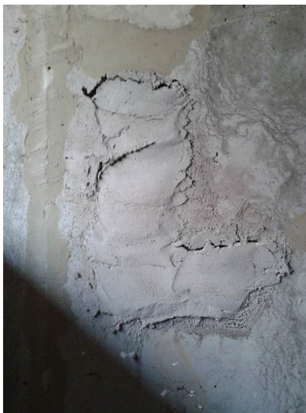
Figura 22 – Incompatibilidade entre o concreto e argamassa utilizada para preenchimento
