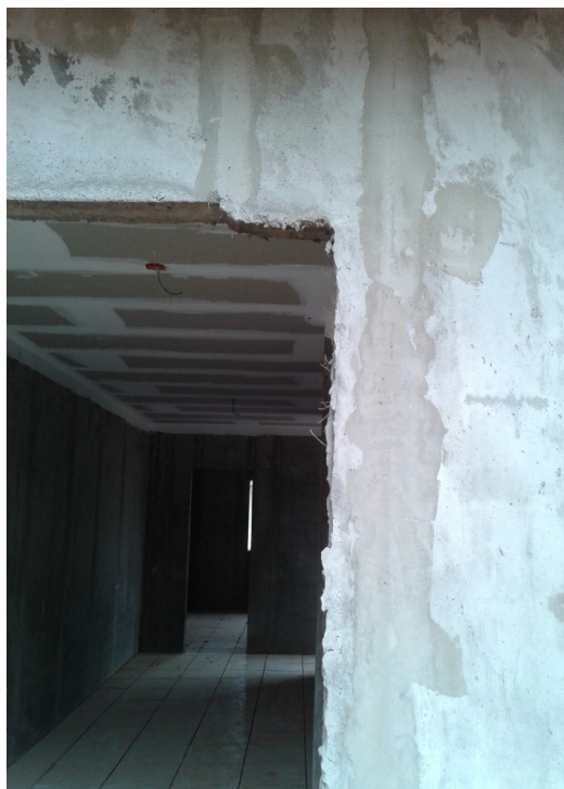
Figura 25 – Porta de entrada apresentando falha na concretagem
