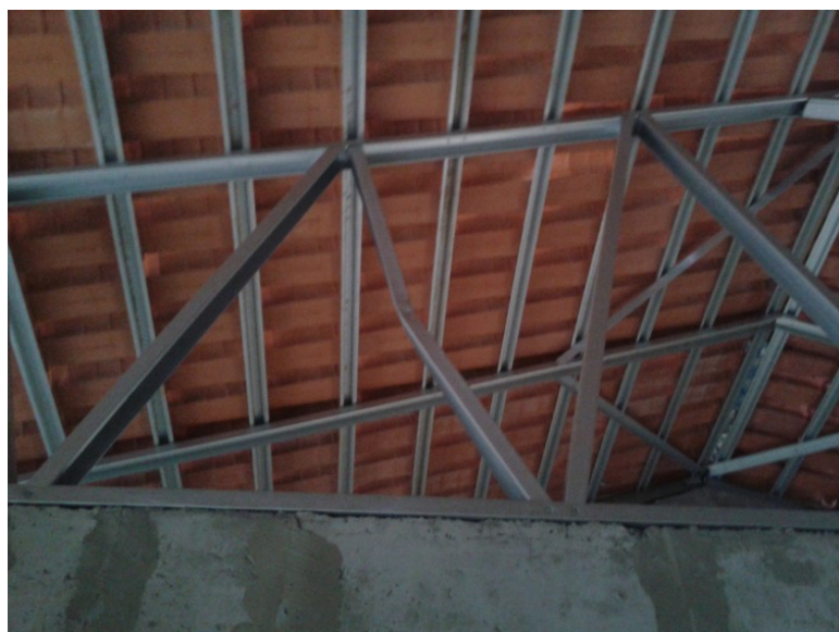
Figura 33 – Estrutura metálica do telhado instalada inadequadamente
