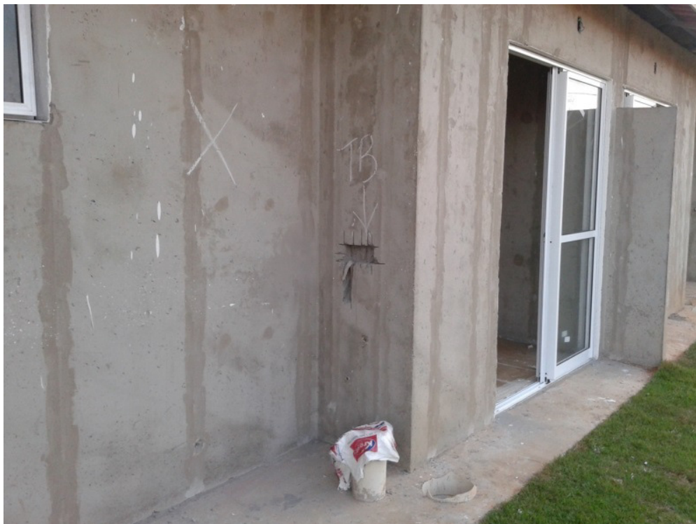
Figura 30, 31 e 32 – Problemas de embutimento das tubulações hidrossanitárias nas paredes
