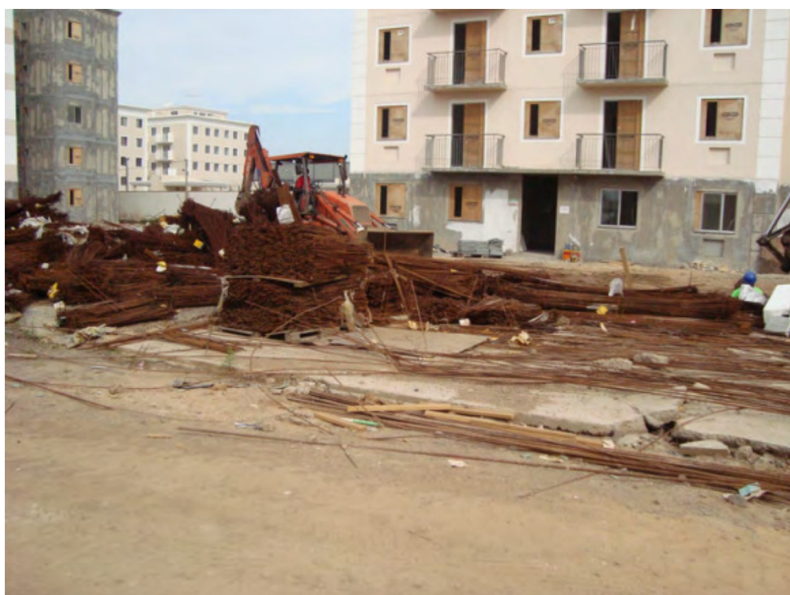
Figura 9 – Armazenagem inadequada de armaduras
