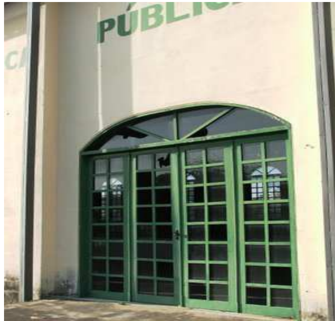
Figura 4 – Vidros quebrados na biblioteca abandonada Fonte: ARAGÃO, 2007
