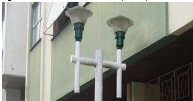
Figura 37 - Luminária decorativa com a parte superior coberta
