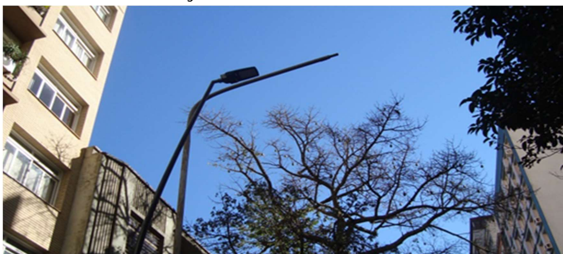
Figura 48 – Posicionamento Luminária de LED
