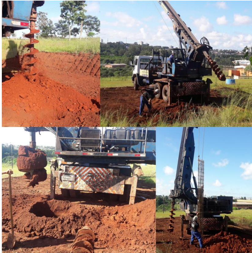
Figura 3.7: Execução da escavação das estacas escavadas com trado rotativo e inserção das armaduras.
