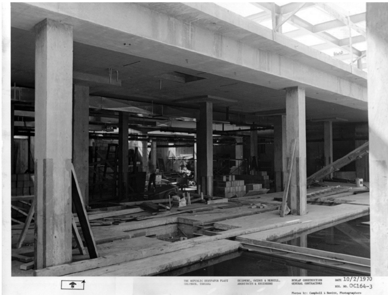
240 Vista do subsolo em direção ao pavimento superior, futura posição da máquina de impressão. Fotografia do período da construção.
