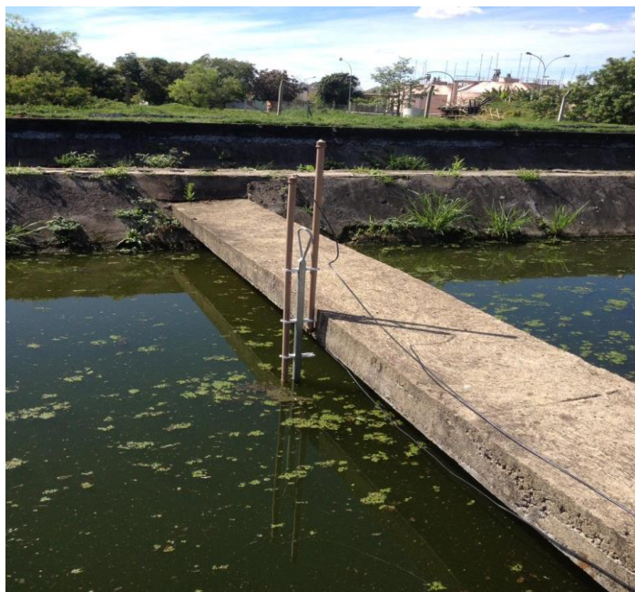
Figura 15. Sensor de radiação solar
