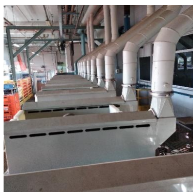
Figura 3.5 Sistema de exaustão acoplado nos tanques utilizados para realização dos testes.
