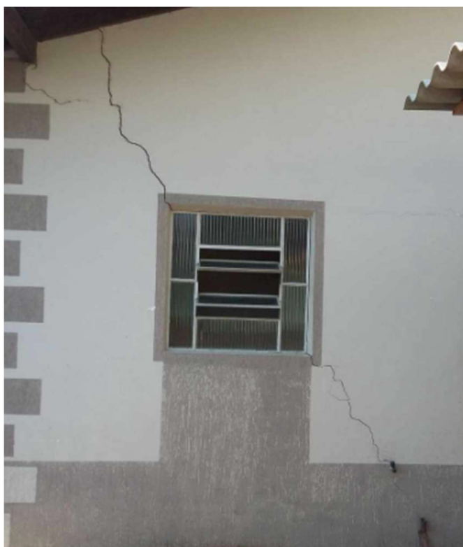
Figura 5 - Fissura característica em áreas com vãos. Fonte: FRANCO (2017)
