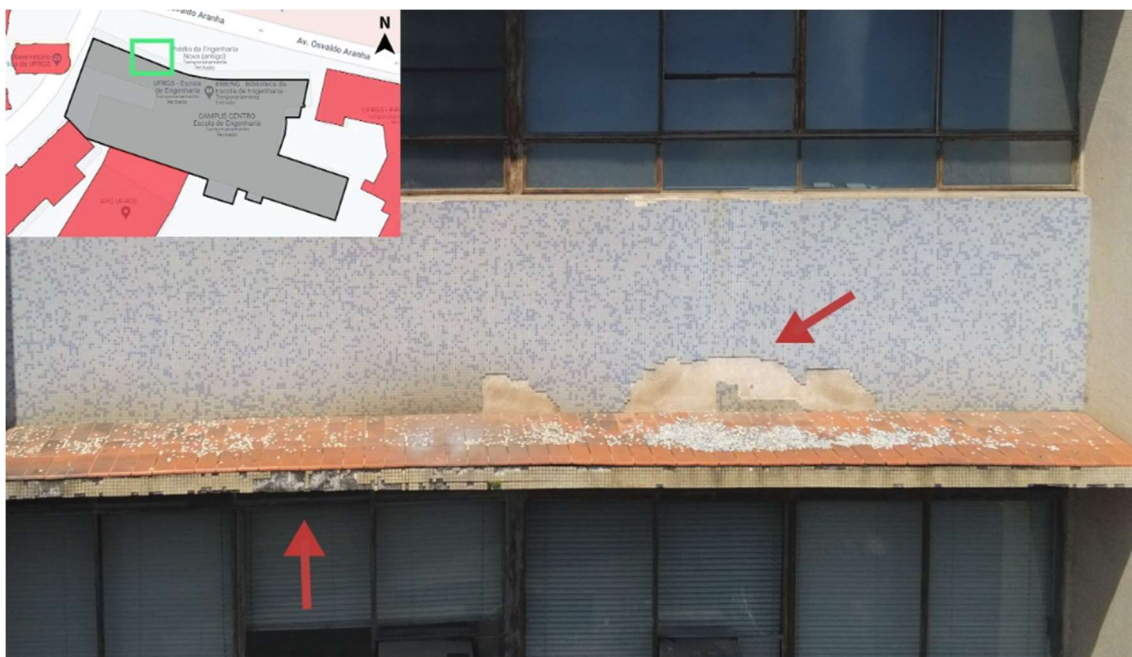
Figura 34 - Descolamento de revestimento cerâmico. Fonte: Autor
