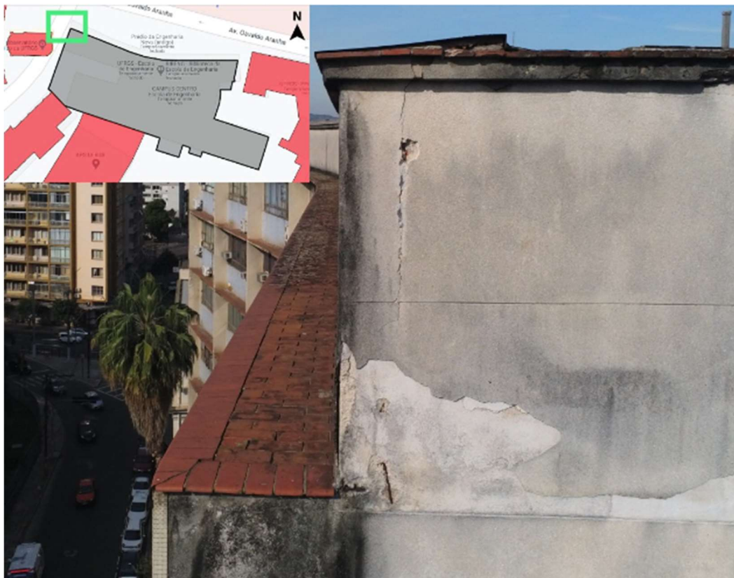
Figura 26 - Fissura vertical em muro de platibanda. Fonte: Autor
