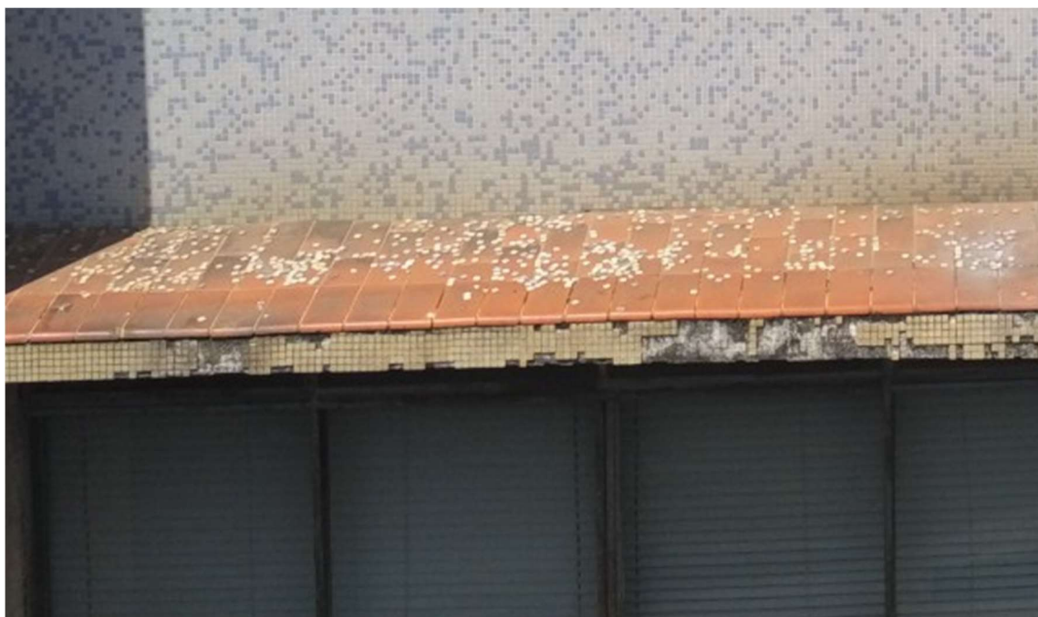
Figura 35 - Marcação residual das pastilhas em área de descolamento. Fonte: Autor
