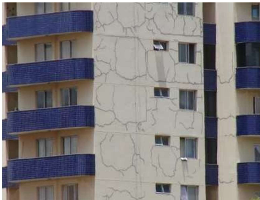
Figura 4 - Fissuras mapeadas em fachada de edifício. Fonte: LEM – UnB, arquivo fotográfico
