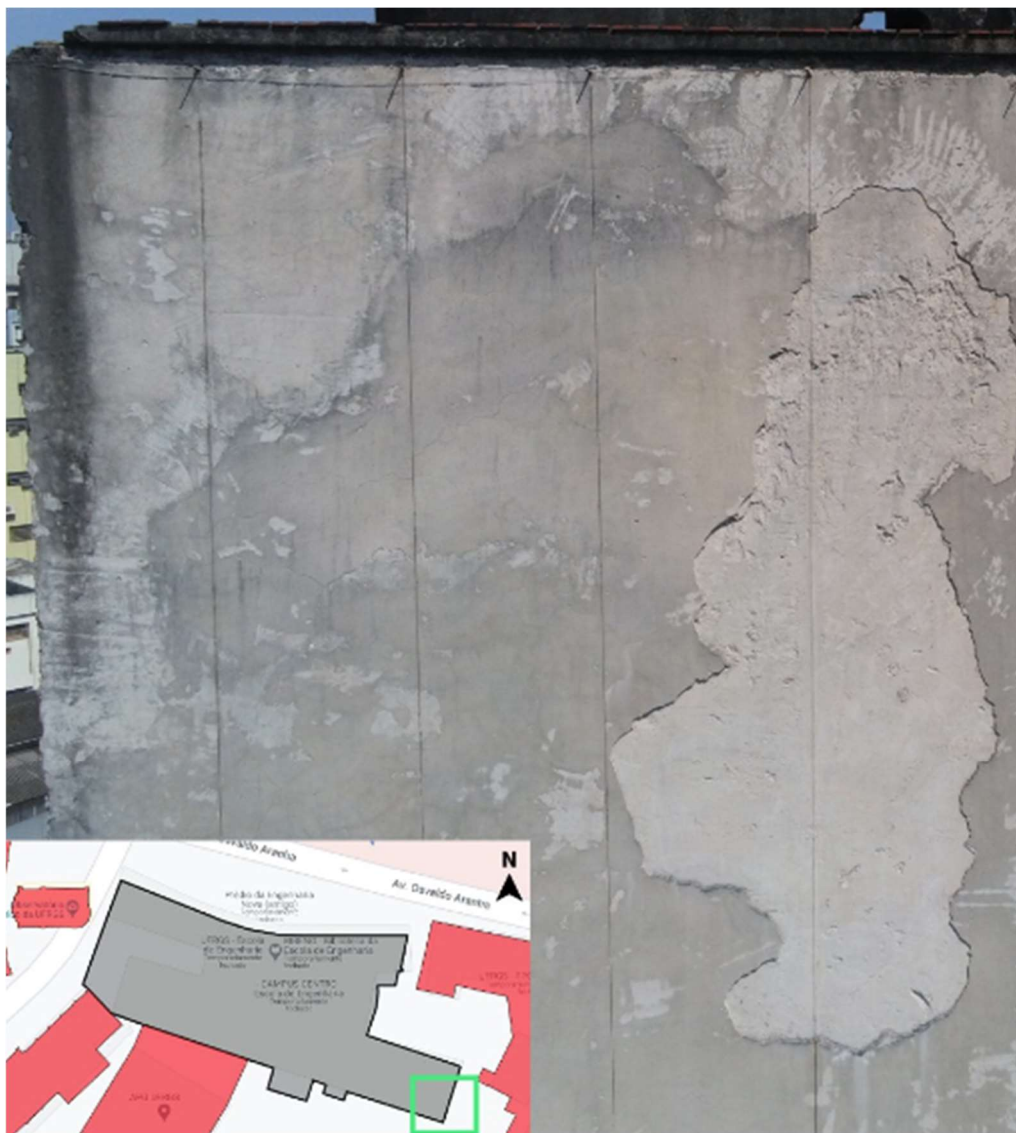
Figura 31 - Fachada com descolamento de placa. Fonte: Autor
