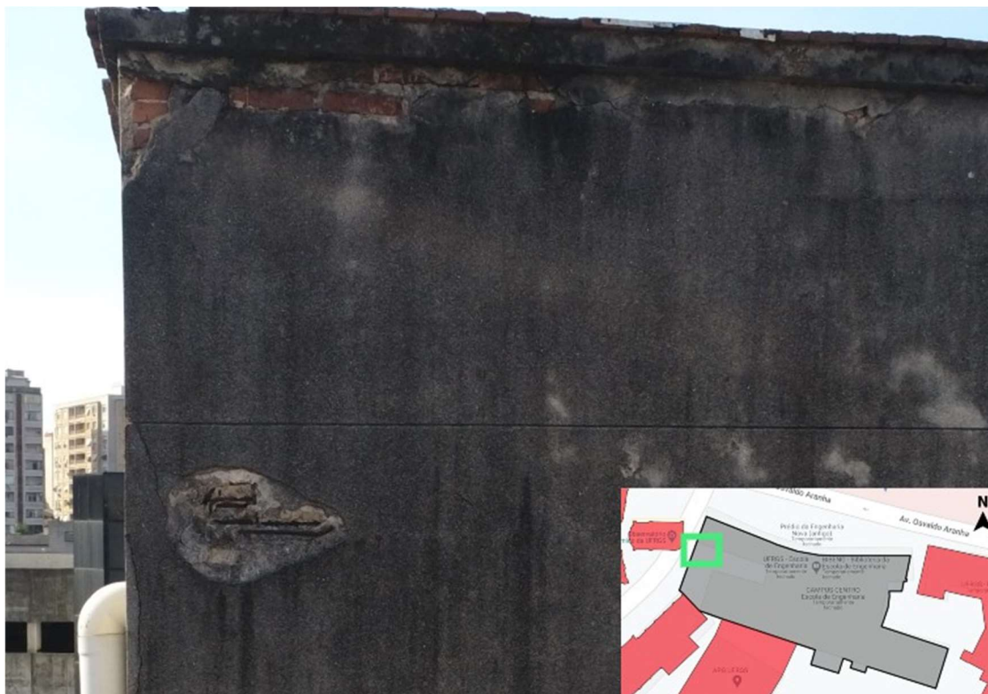
Figura 33 - Descolamento de revestimento com exposição de armadura. Fonte: Autor
