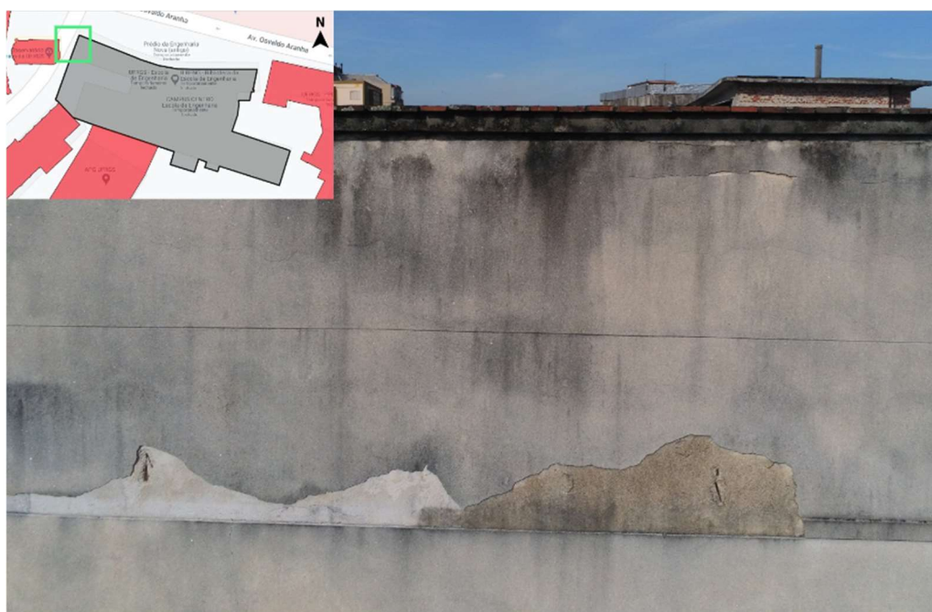
Figura 30 - Área com revestimento descolado. Fonte: Autor
