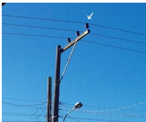
Figura 3.1 - Isolador de Porcelana 25 kV. Fonte: O autor (2019).
