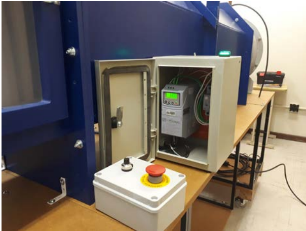
Figura 24 Quadro de acionamento com inversor, disjuntor e comando remoto do TV.
