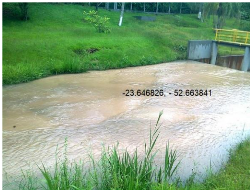
Figura 5. Assoreamento da barragem da represa.
