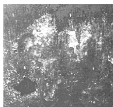
Figura 16 – Eflorescência e manchas
