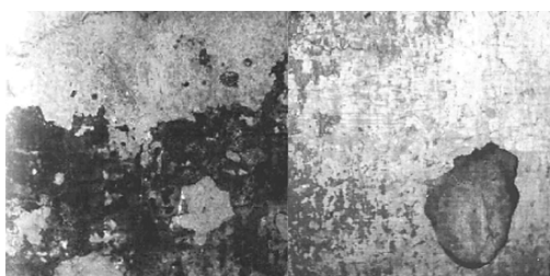
Figura 15 – Descolamento de pintura e da argamassa
