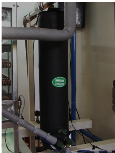
Reservatório de Líquido
