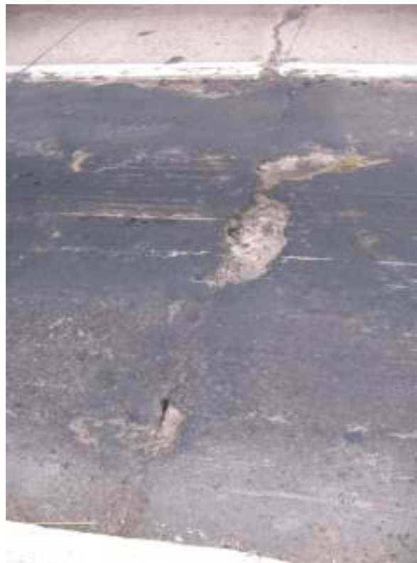
Figura 11 – Propagação da fissuras devido às juntas de dilatação e formação de panelas
