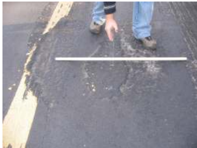
Figura 14 – Remendo com afundamento de 4 cm
