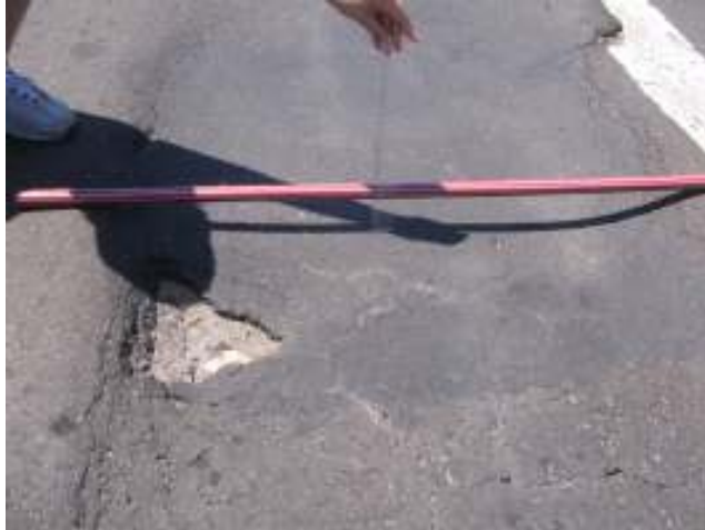
Figura 25 – Afundamento com remendo, escorregamento do revestimento e panela
