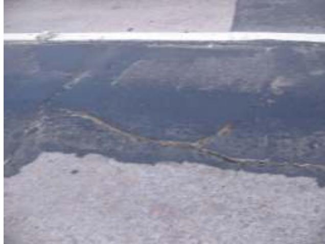
Figura 10 – Propagação das fendas existentes na camada inferior para o revestimento
