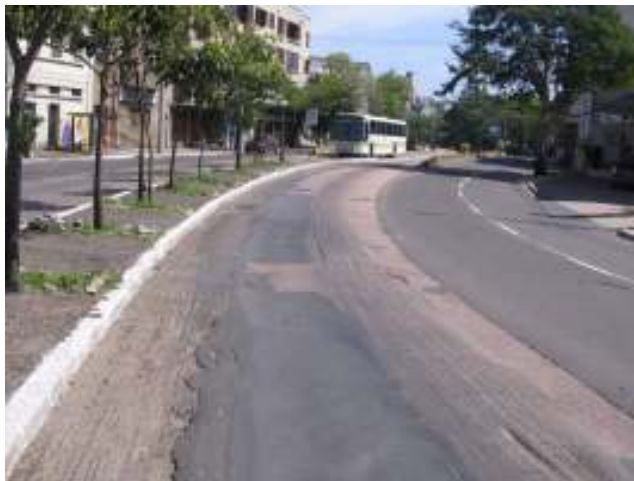
Figura 39 – Trecho em curva com trilha de rodas e escorregamento do revestimento
