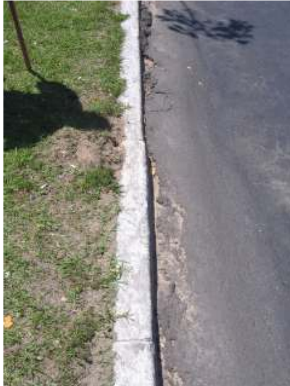
Figura 22 – Escorregamento do revestimento
