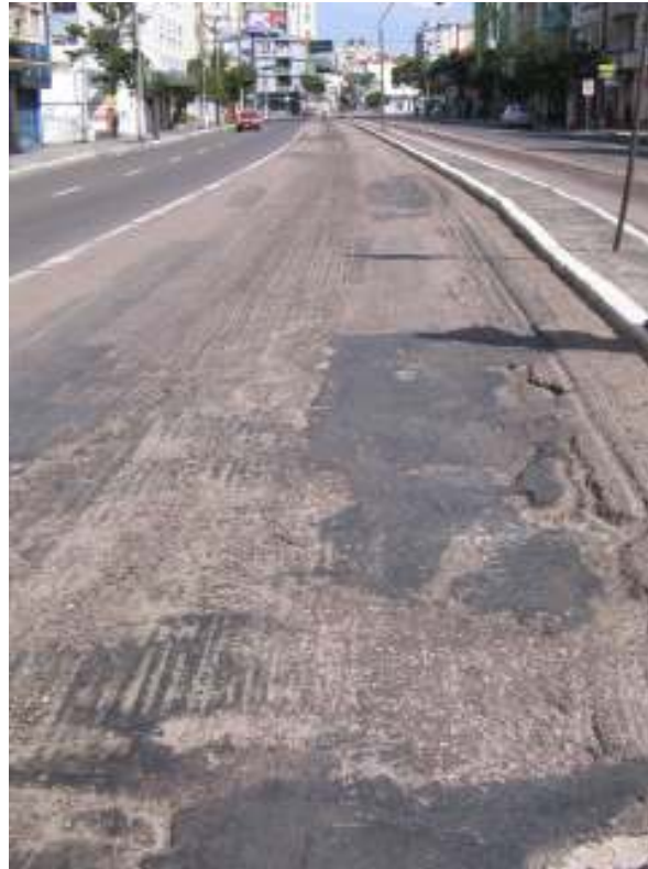
Figura 31 – Exemplo de panelas, exsudação e desprendimento dos grãos da mistura asfáltica
