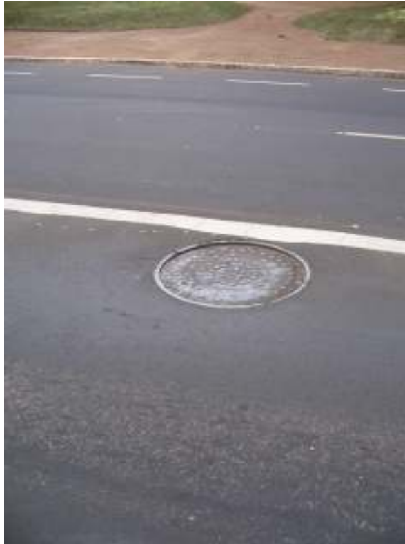
Figura 15 – Afundamento em torno de tampa de rede de esgoto
