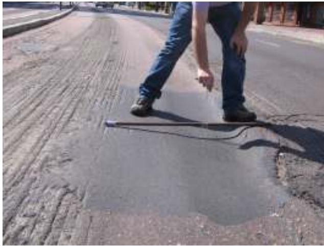
Figura 30 – Afundamento de 6 cm e escorregamento do revestimento
