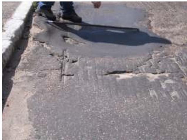
Figura 35 – Afundamento e escorregamento do revestimento com profundidade de aproximadamente 9 m
