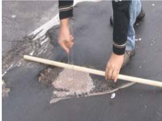
Figura 12 – Panela com profundidade aproximada de 5cm
