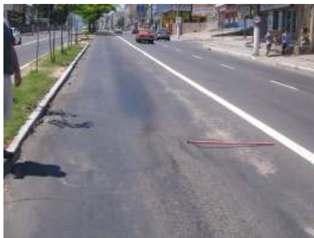
Figura 21 – Afundamento ao lado da via (6 cm)
