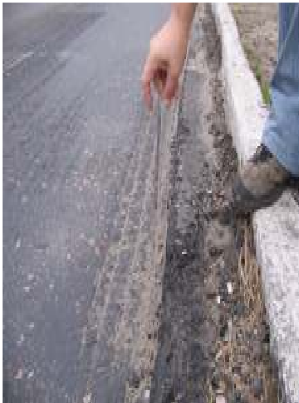
Figura 29 – Detalhe da altura do escoamento mesmo após fresagem
