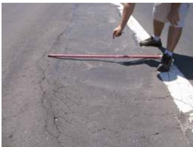
Figura 24 – Afundamento com remendo, escorregamento do revestimento e trincas parabólicas
