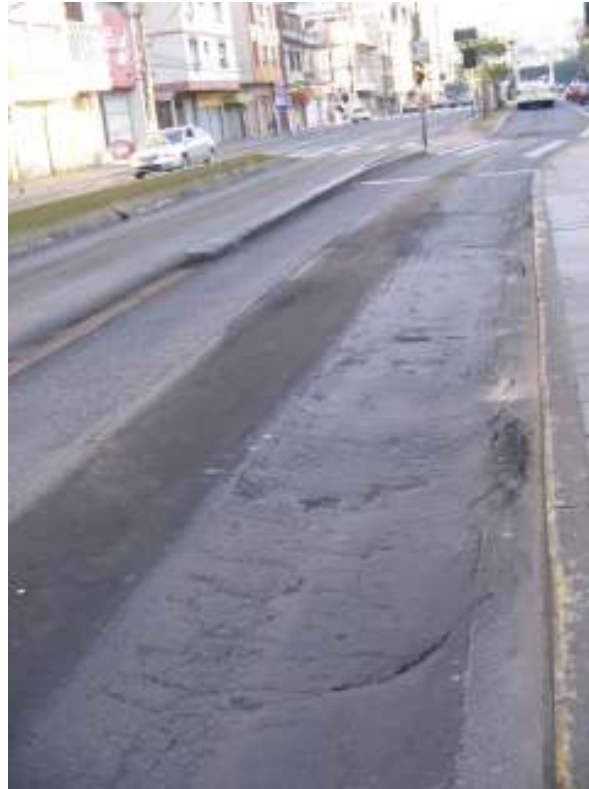
Figura 13 – Escorregamento com consolidação de trilha de roda
