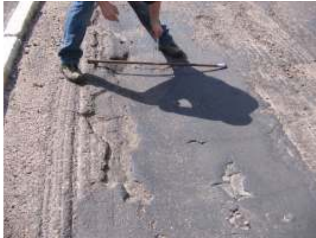
Figura 33 – Detalhe da figura 32 demonstrando a profundidade do afundamento
