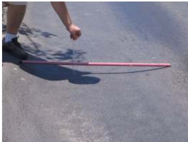
Figura 20 – Afundamento ao lado do meio-fio (9 cm)
