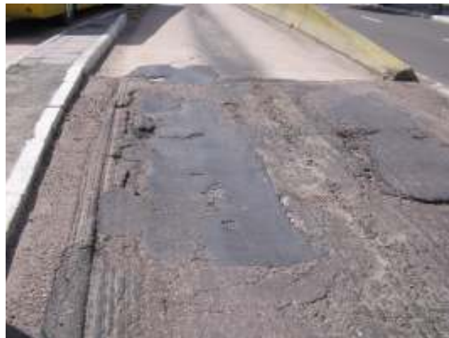
Figura 32 – Exemplo de panelas, exsudação, escorregamento e desprendimento dos grão da mistura asfáltica
