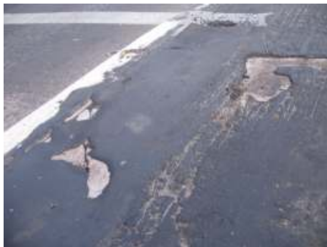
Figura 9 – Escorregamento do revestimento acompanhado de exsudação
