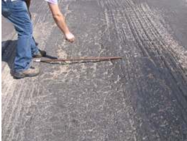
Figura 38 – Envelhecimento da mistura, afundamento de 5 cm e exsudação
