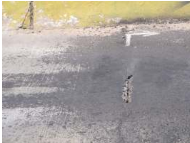
Figura 18 – Propagação de trincas
