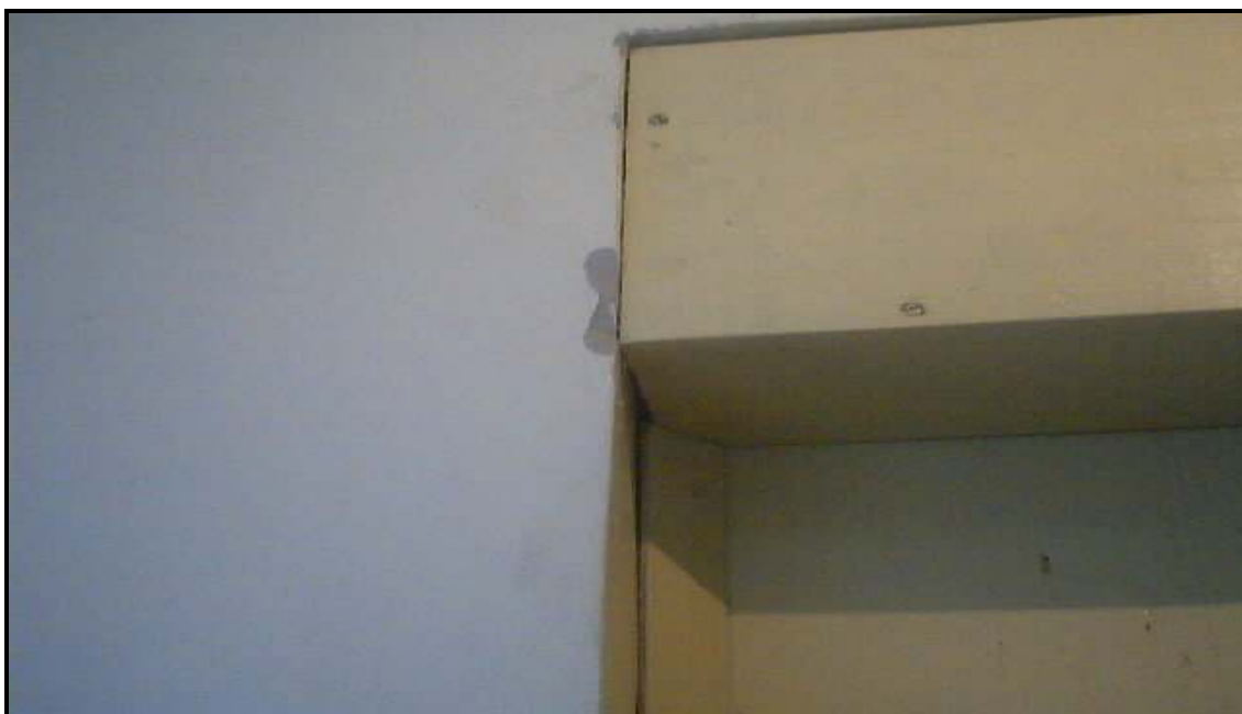
Figura 6: descolamento no revestimento argamassado de alvenaria
