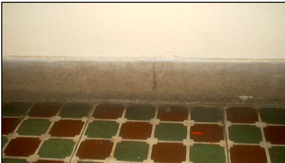
Figura 23: fissura e sujeidade no detalhe de granitina
