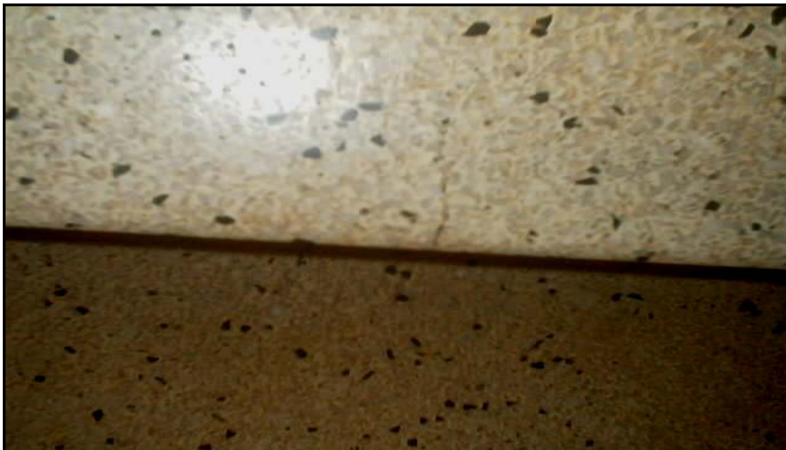
Figura 20: fissura na granitina sobre o degrau da escada entre o segundo e terceiro pavimentos
