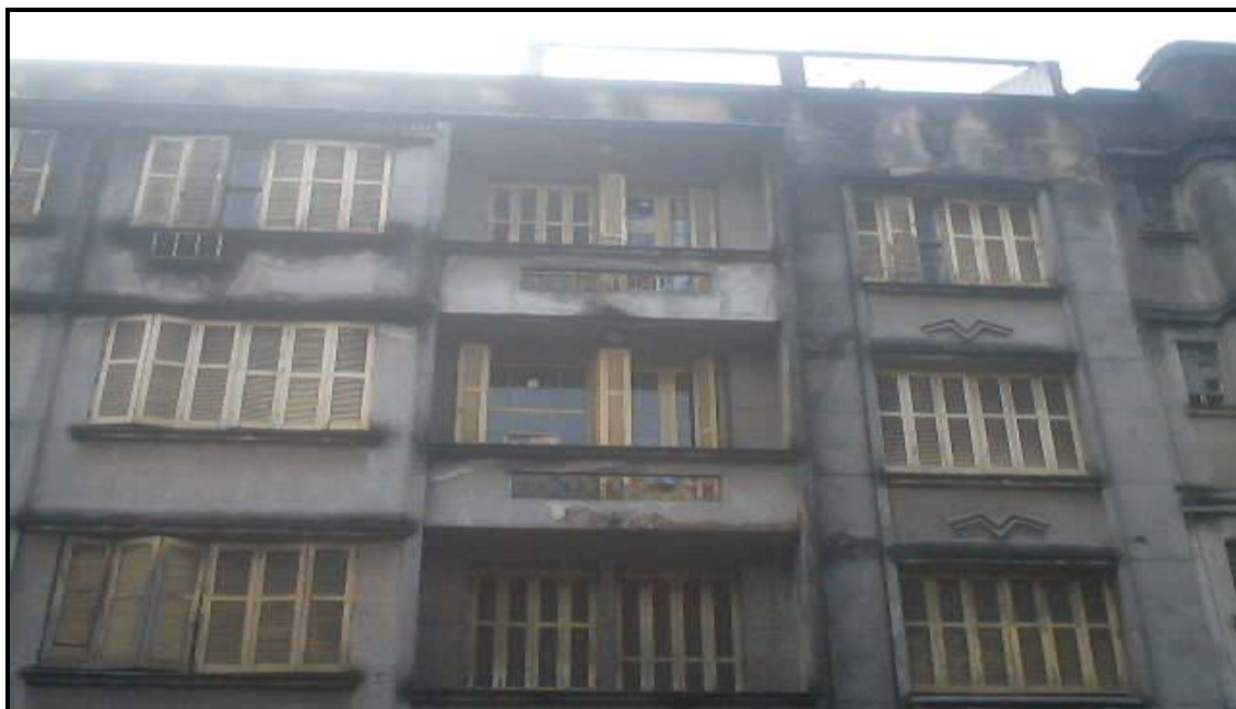
Figura 32: descolamento em placa no revestimento argamassado de fachada
