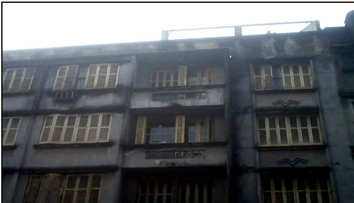
Figura 31: mofo no revestimento argamassado de fachada
