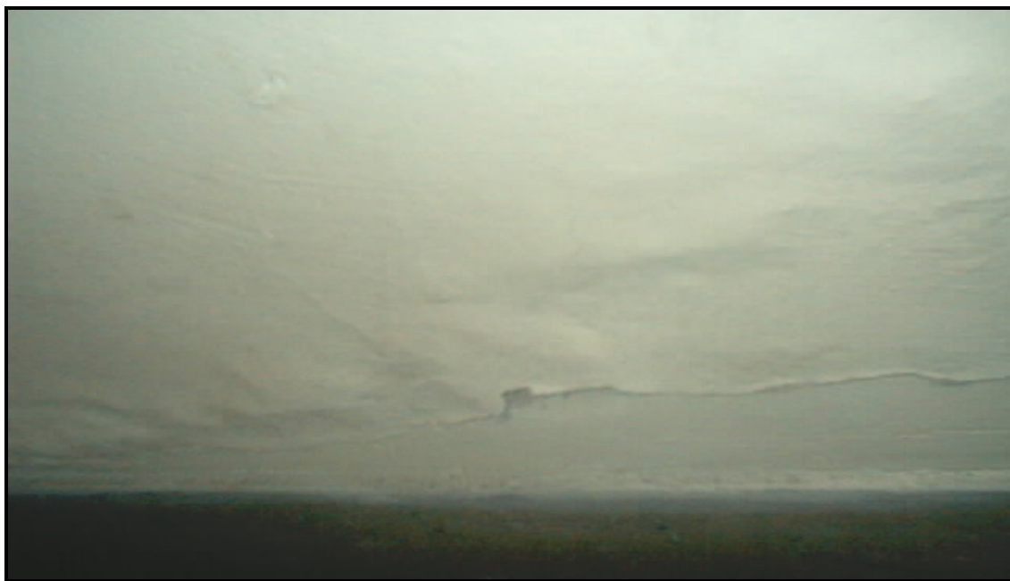
Figura 27: descolamento com empolamento no revestimento argamassado de alvenaria
