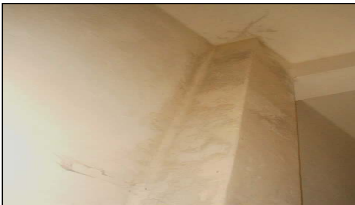
Figura 7: manchamento e inchamento no revestimento argamassado de pilar e de alvenaria
