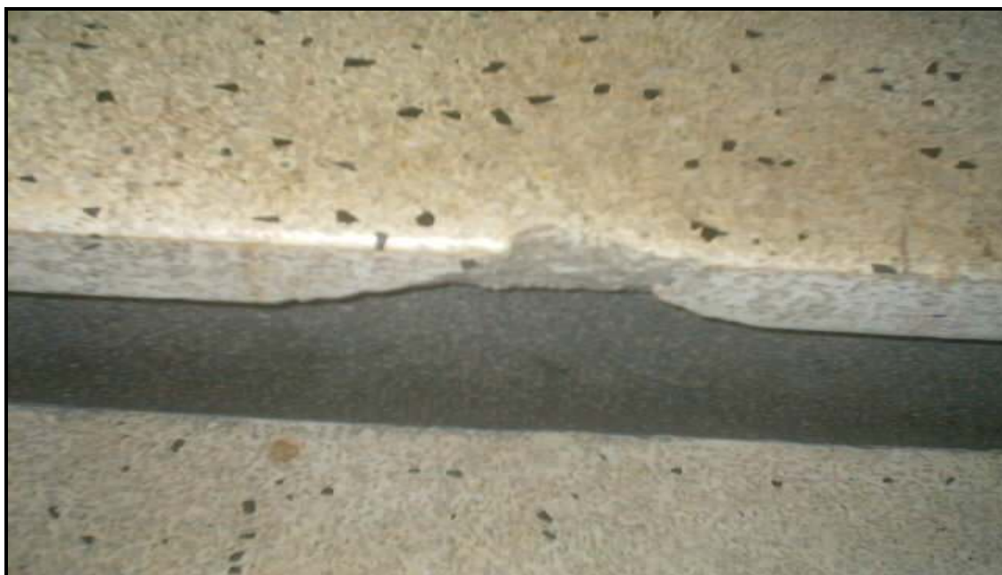
Figura 16: fratura na granitina sobre o degrau da escada entre o primeiro e segundo pavimentos
