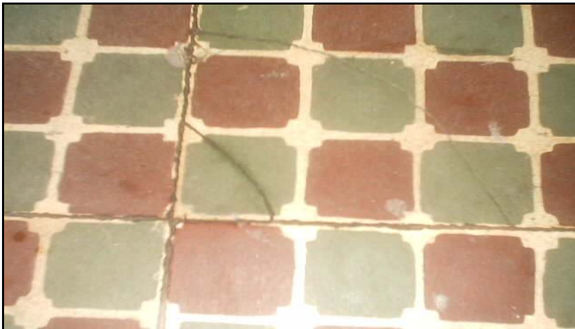
Figura 10: fissura no revestimento de ladrilho hidráulico de piso
