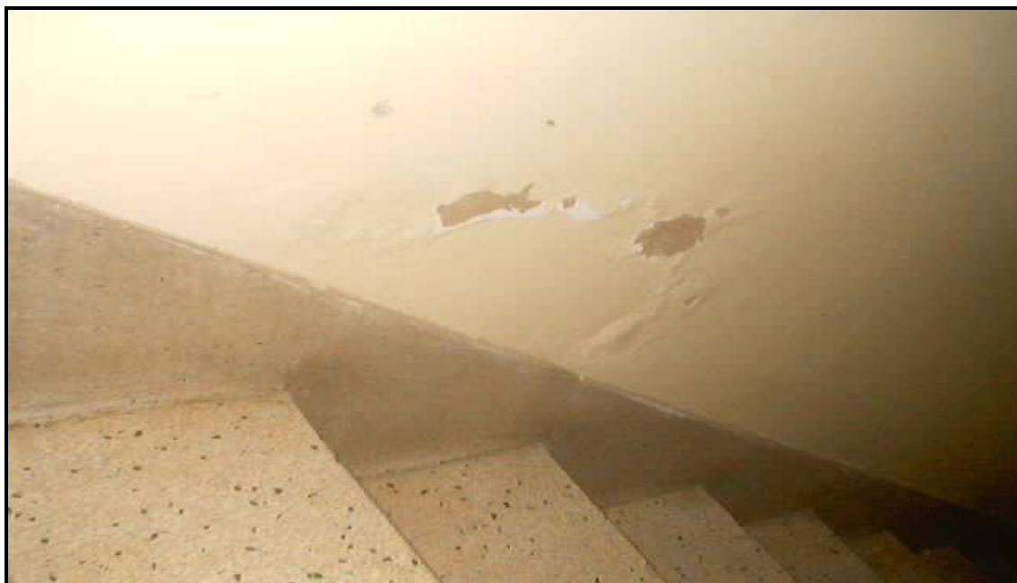
Figura 11: vesícula no revestimento argamassado de alvenaria
