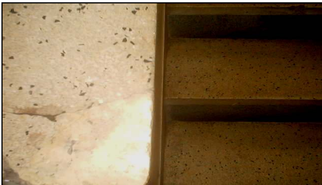
Figura 24: fissura na placa de granitina do corrimão da escada entre o terceiro e quarto pavimentos
