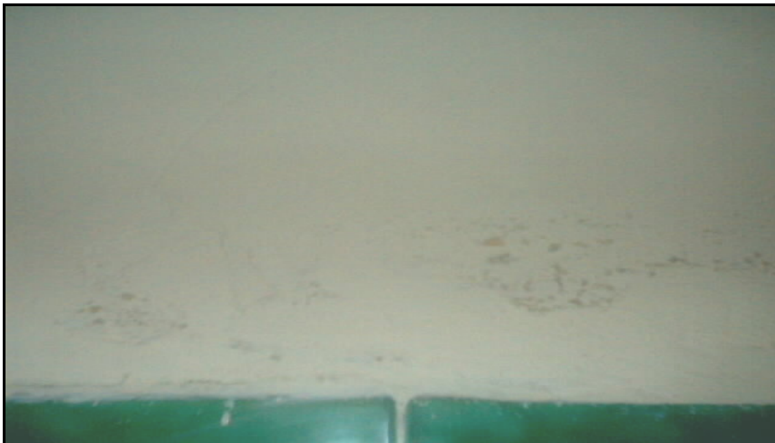
Figura 9: mofo e descolamento com pulverulência no revestimento argamassado de alvenaria
