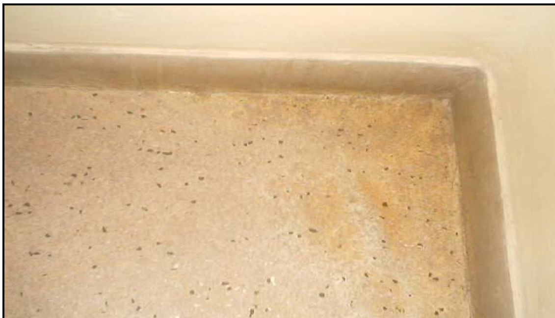
Figura 15: manchamento no patamar de granitina da escada entre o primeiro e segundo pavimentos
