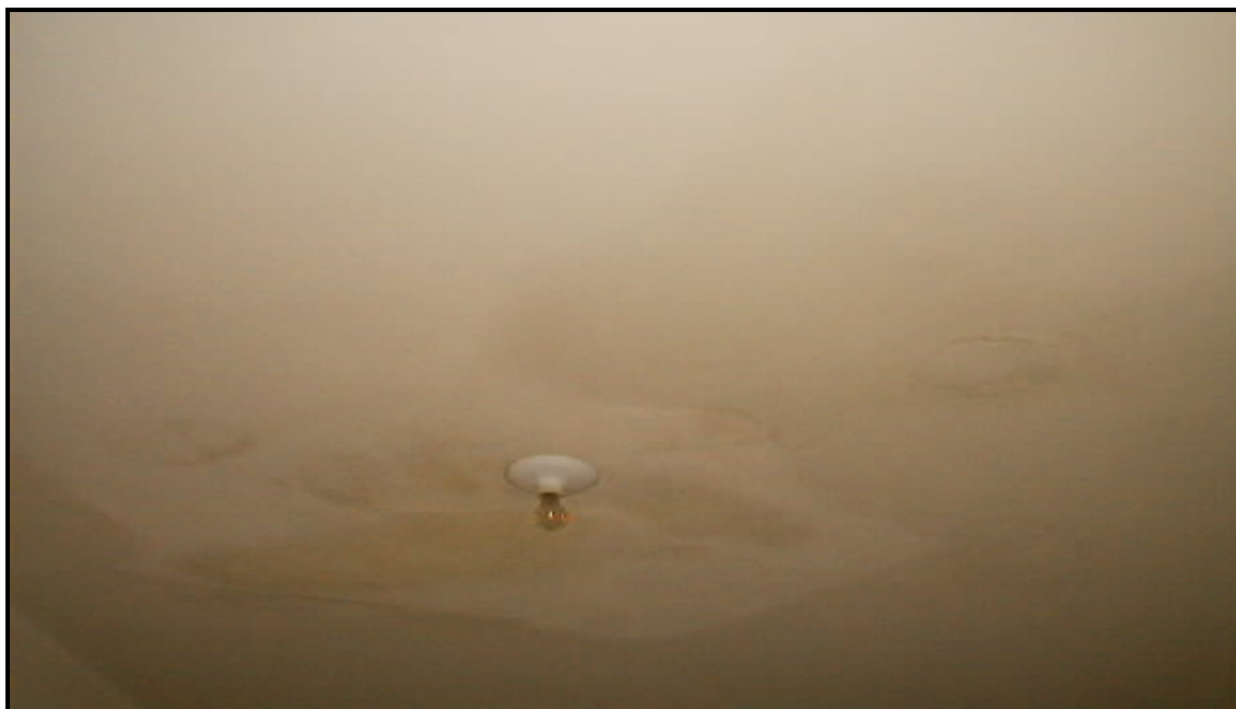
Figura 28: manchamento no revestimento argamassado de teto
