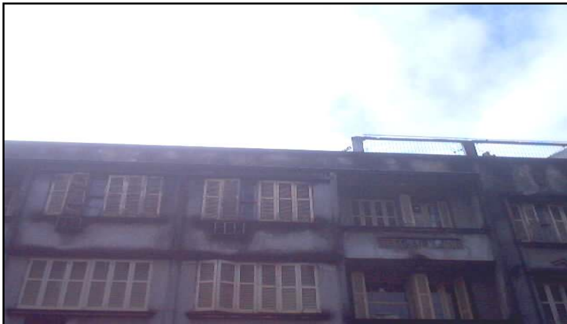
Figura 30: sujidade e escorrimento no revestimento argamassado de fachada
