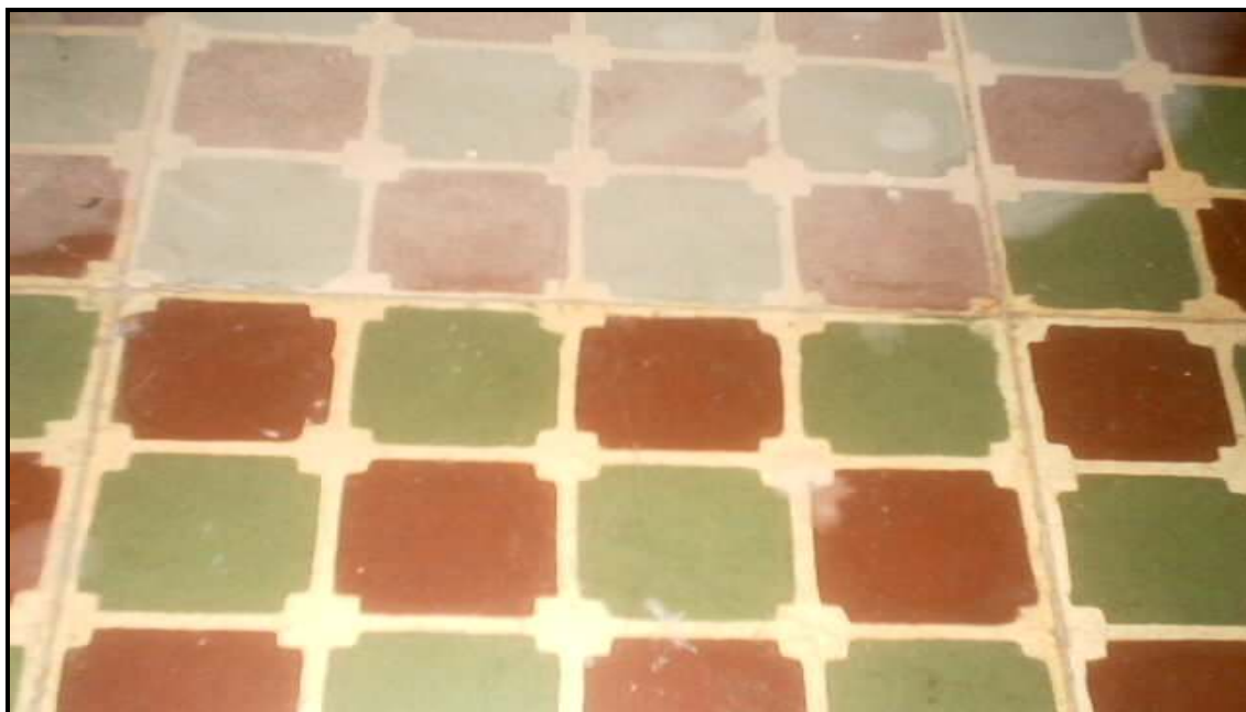
Figura 19: desbotamento no revestimento de ladrilho hidráulico de piso
