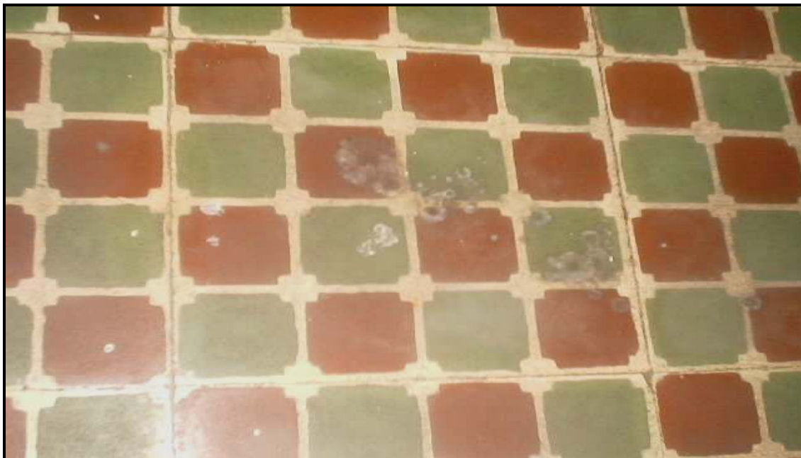
Figura 14: manchamento no revestimento de ladrilho hidráulico de piso
