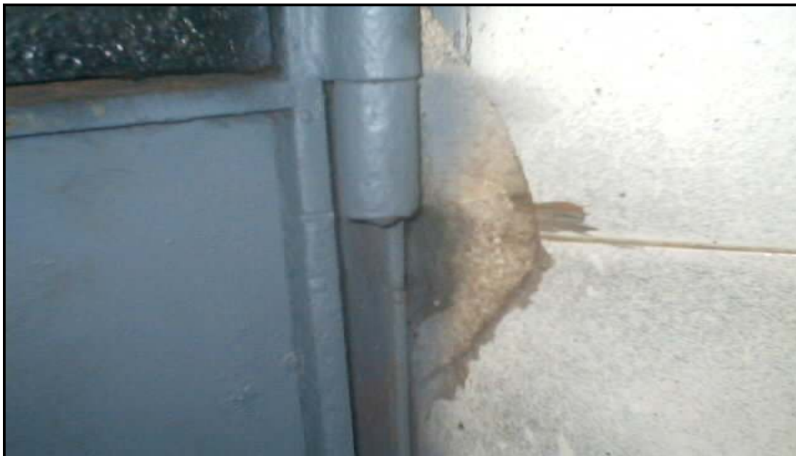
Figura 5: descolamento e sujidade no azulejo
