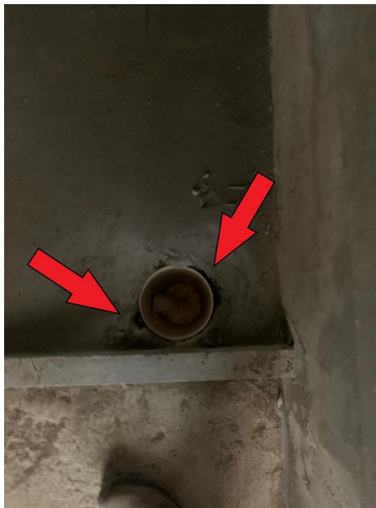
Figura 14 - Regularização com falhas em volta do ralo antes de receber impermeabilização.
