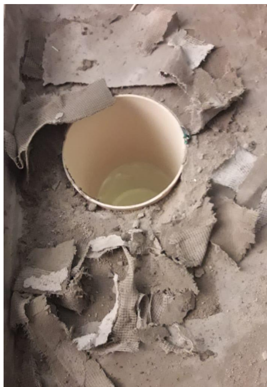
Figura 16 - Impermeabilização danificada na região do ralo.
