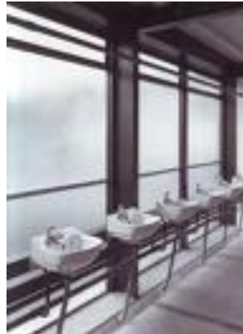
Figura 20 - Foto interna de Hunstanton, mostrando as instalações aparentes
