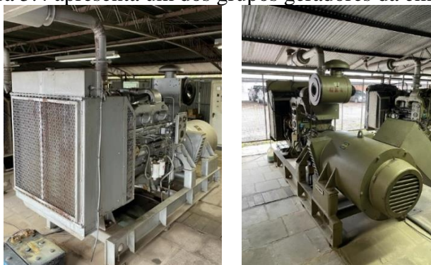
Figura 5.4 – Grupo gerador da marca Negrini.
