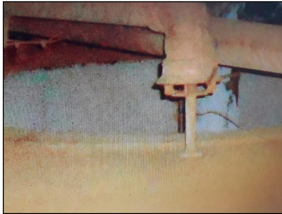
Figura 11: Saída do braço móvel do tanque TQ-41.
