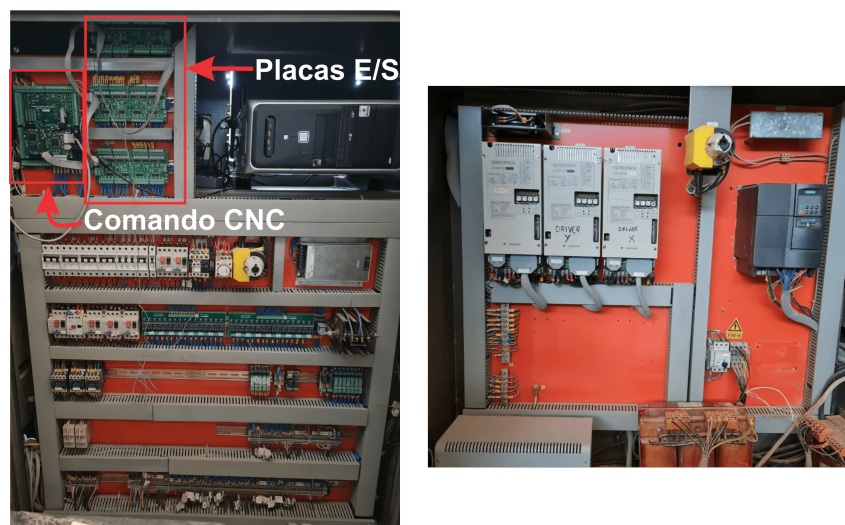
Figura 18: Painel elétrico contendo as placas de E/S próximas ao comando.
