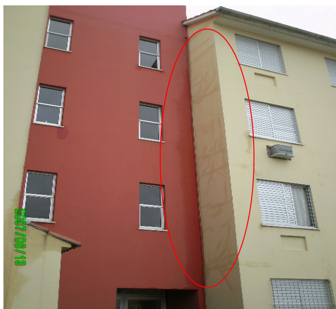
Figura 11: fissuras mapeadas do empreendimento do PAR (CAIXA ECONÔMICA FEDERAL, 2007)
