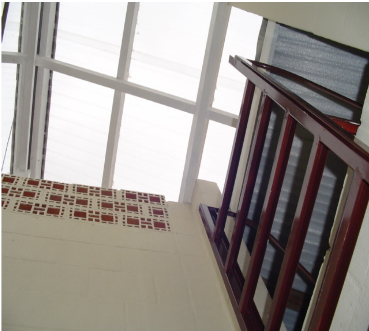
Figura 32: clarabóia (CAIXA ECONÔMICA FEDERAL, 2007)
