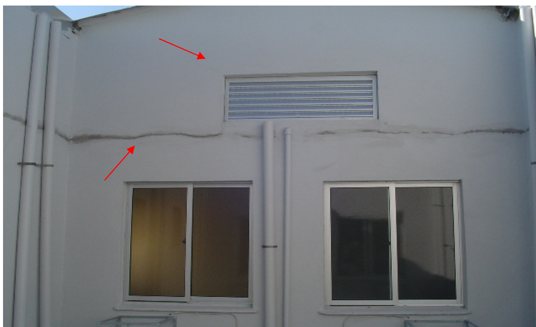
Figura 28: restauração da fissura da parede em função da laje de cobertura (CAIXA ECONÔMICA FEDERAL, 2008)
