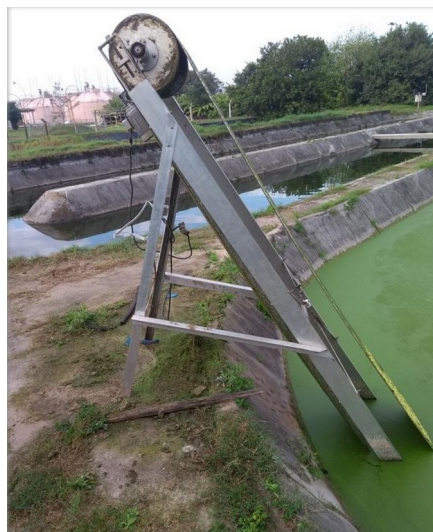
Figura 3: Registro fotográfico da esteira retiradora de macrófitas, instalada ao final da LM.
