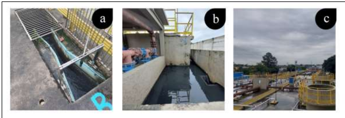
Figura 2: Estação de Tratamento de Esgotos, onde: (a) calha Parshall, onde foi realizada a coleta de efluente bruto, (b) local de coleta de amostras pós-tratamento e (c) vista geral da ETE.
