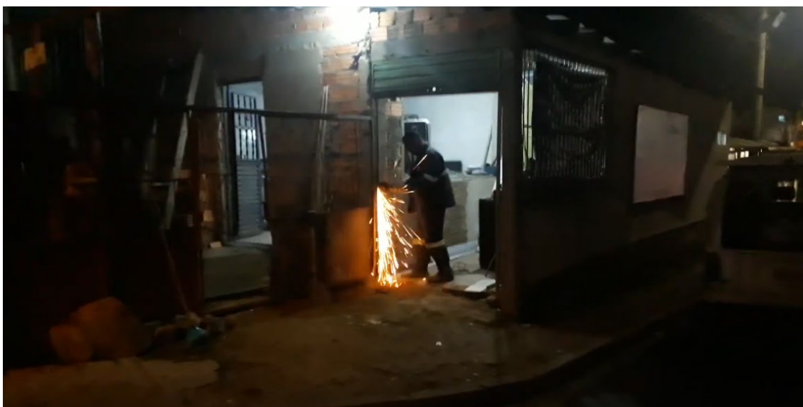
Figura 18: Manutenção porta de ferro.
