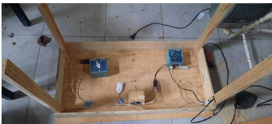
Figuras 3 e 4. A mesa montada (acima) e a parte inferior com a instalação elétrica (abaixo). Fonte: acervo do Grupo.
