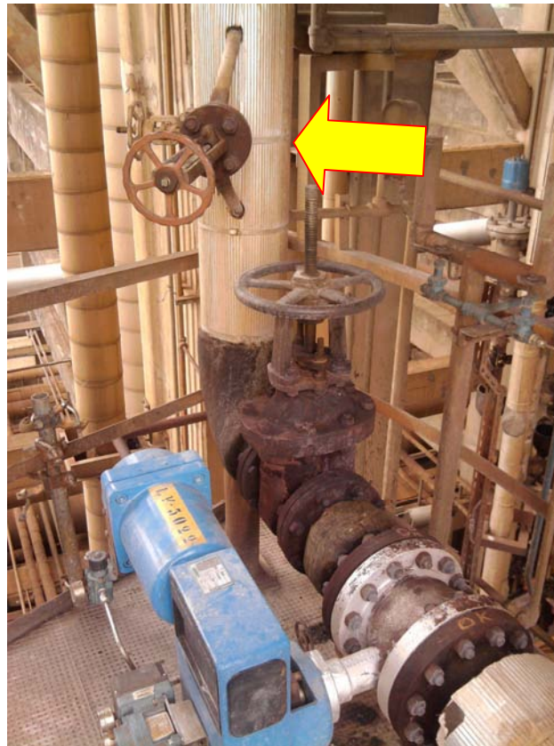
Figura 18 - Ponto de controle de corrosão em diesel leve (PONTO 3)
