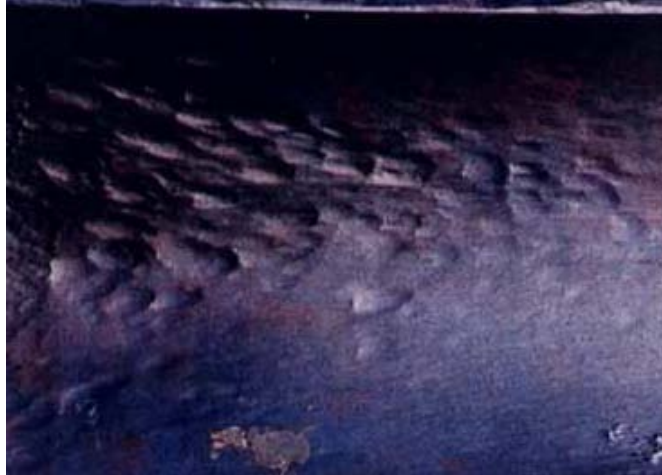
Figura 4 - Superfície corroída em tubulação com escoamento turbulento (9).
