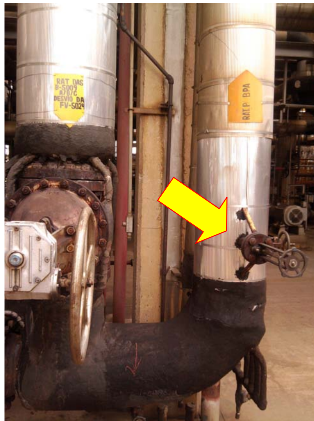
Figura 22 - Ponto de controle de corrosão em RAT (PONTO 5)
