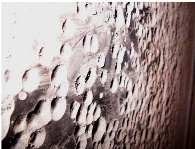
Figura 5 - Corrosão alveolar por condensação no costado da torre.
