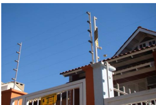
Figura 7 – Grades e cercas elétricas.
