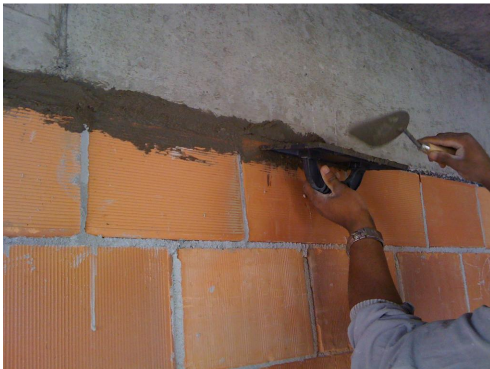
Figura 16: fixação com argamassa podre
