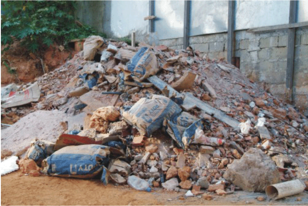
Figura 2: entulho não segregado
