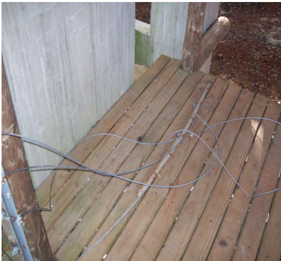
Figura 7 – furtos dos cabos de aço do Mirante Imagem: a autora
