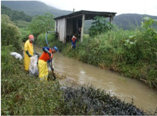
Figura 13 – Contenção do vazamento da emulsão asfáltica Imagem: www.osorio.rs.gov.br Gabriela Pacheco
