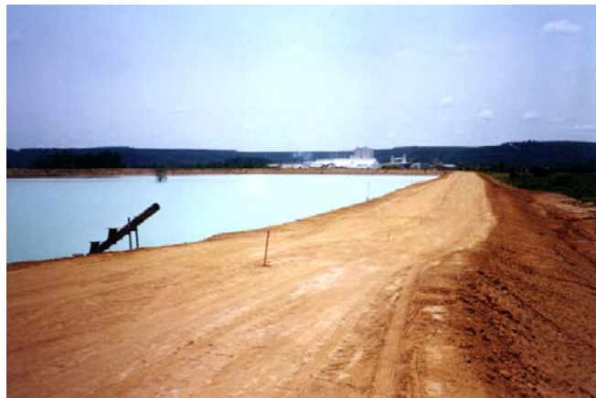
FIGURA 19 - Tubo extravasor por onde a água da polpa é removida da lagoa.
